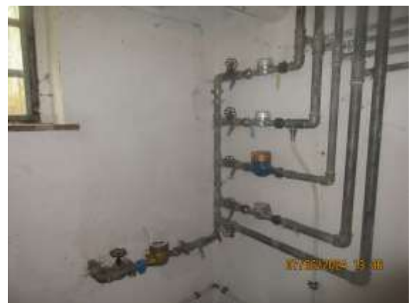
Sep. Wasseruhren / Kaltwasser
