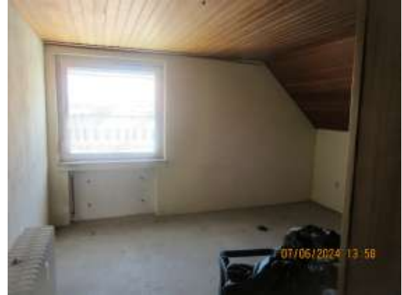
ausgebautes Zimmer ohne Fußbodenbelag ohne Heizkörper
