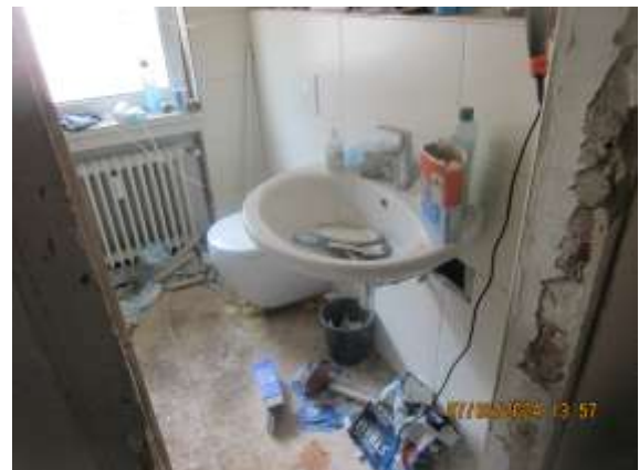
Bad / nicht fertiggestellt
