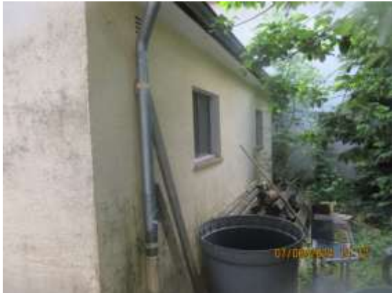
Nordfassade Doppelgarage / Putz- und Anstrichschäden
