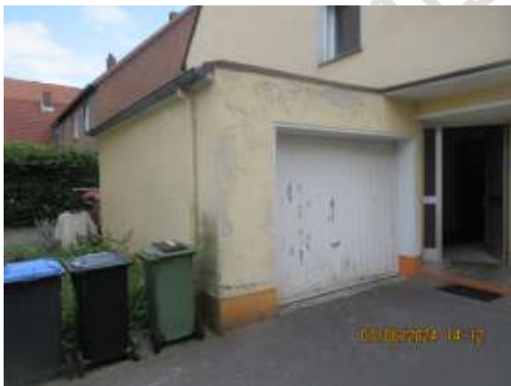
Angebaute Garage / Putz- und Anstrichschäden
