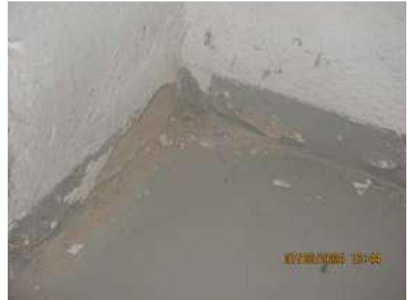
Putz- Anstrichschäden / Kellerwände
