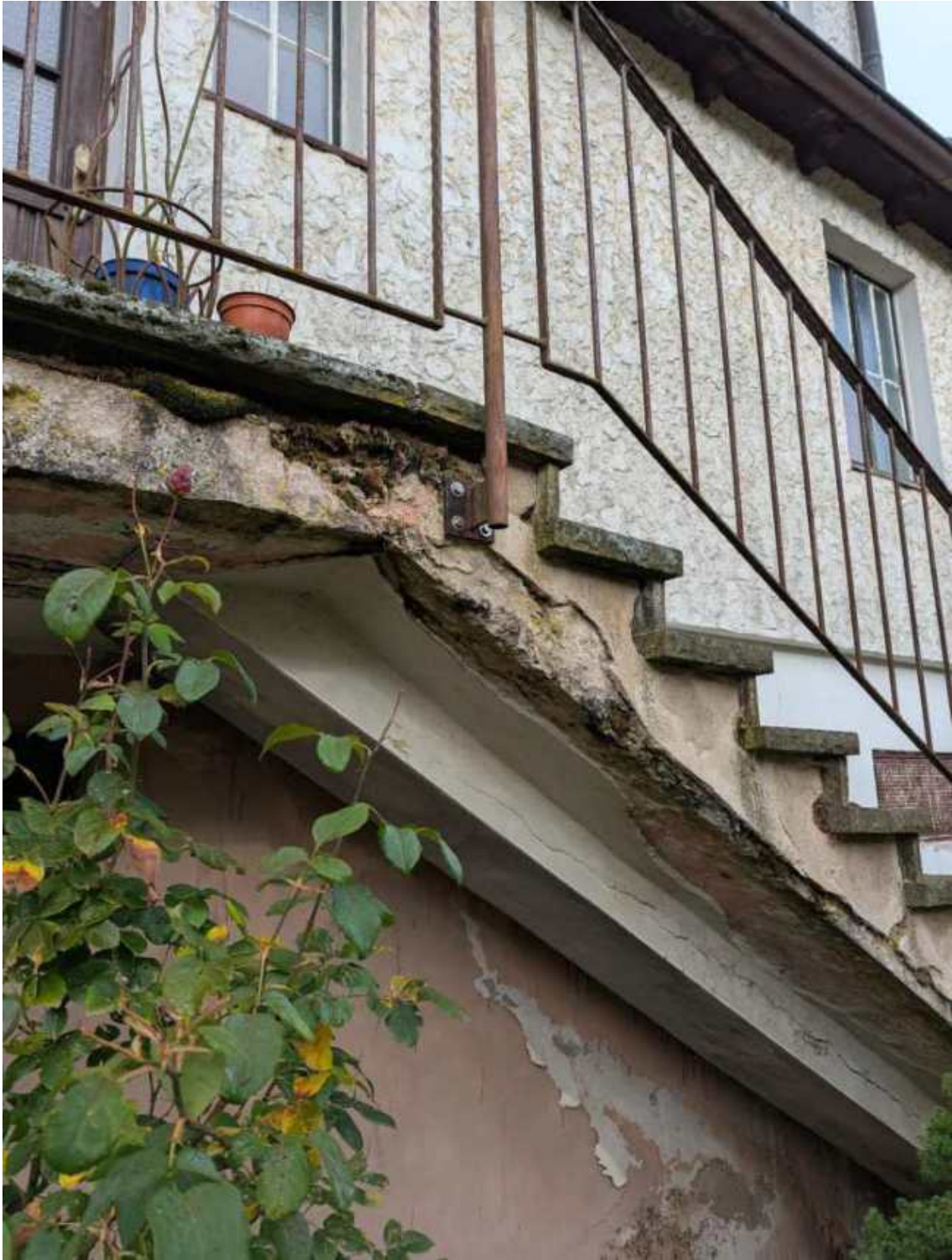
Lfd. Nr. 1 Wohnhaus Schäden am Außenputz
