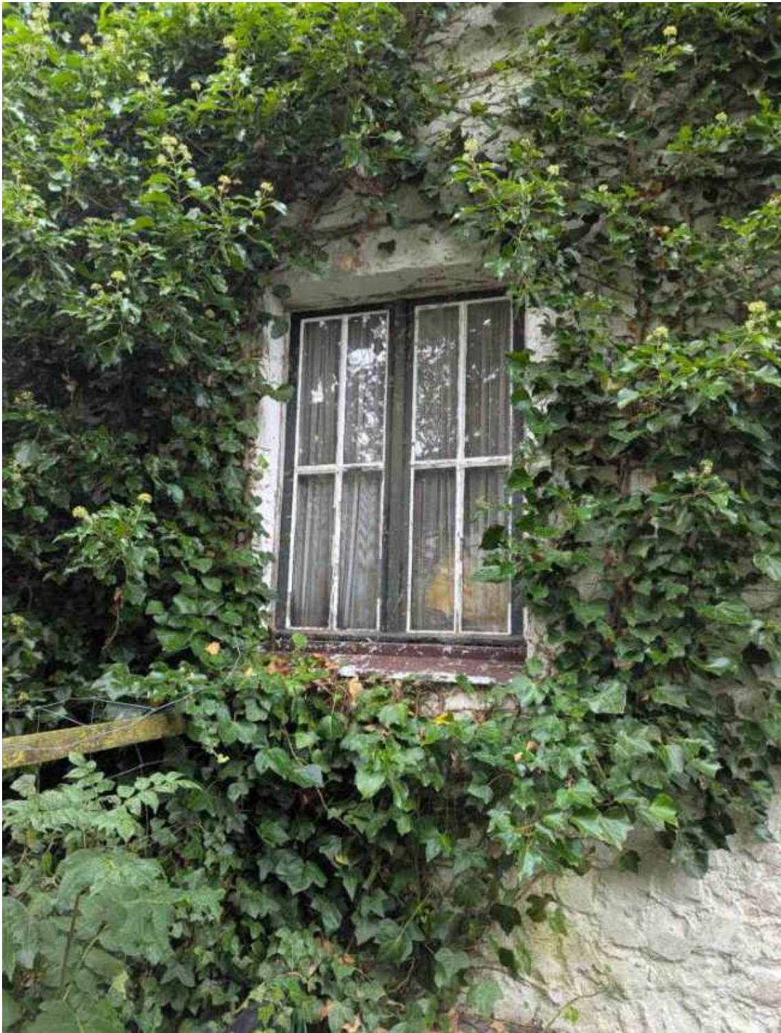
Lfd. Nr. 1 Wohnhaus Bewuchs an Hauswand
