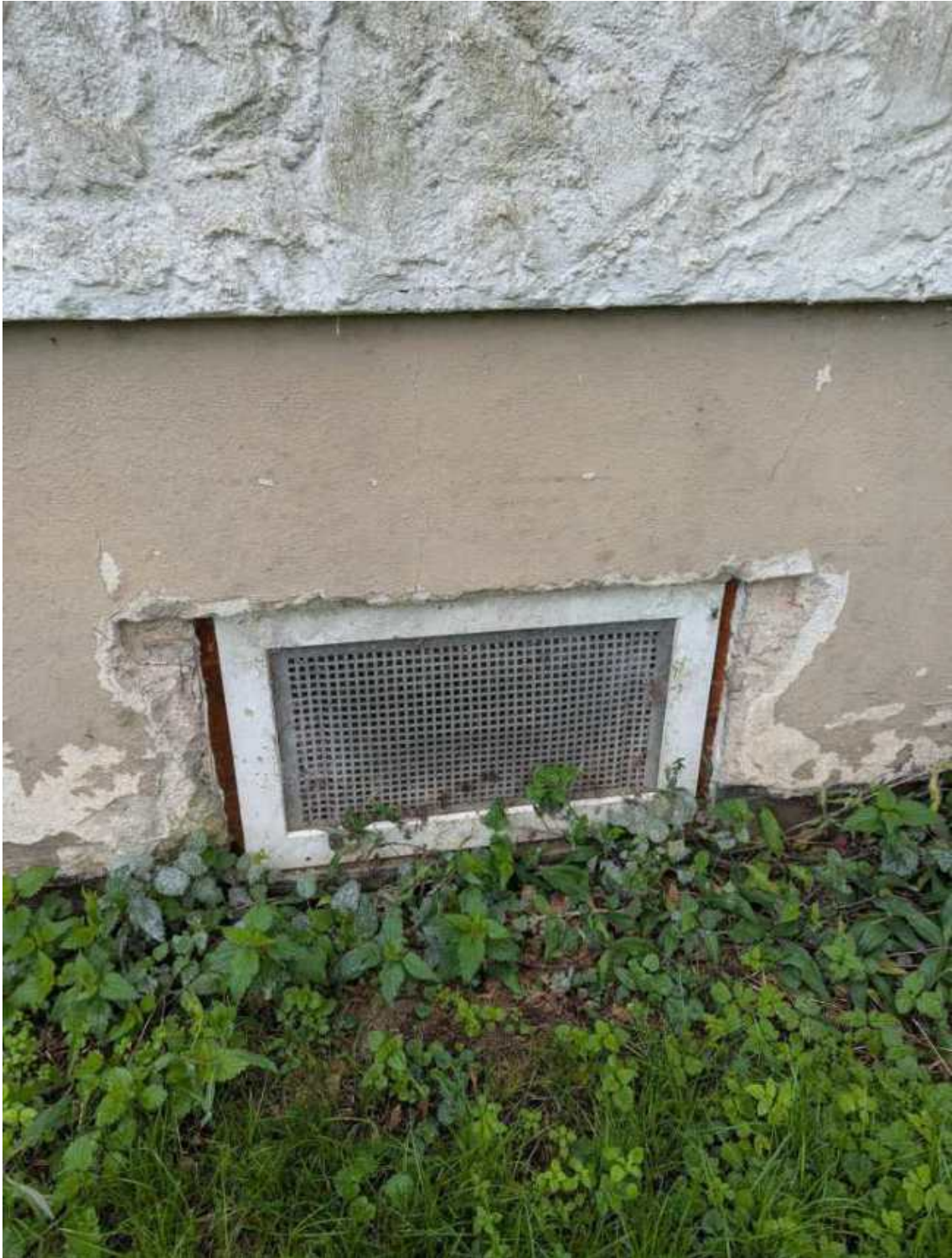
Lfd. Nr. 1 Wohnhaus Kellerfenster
