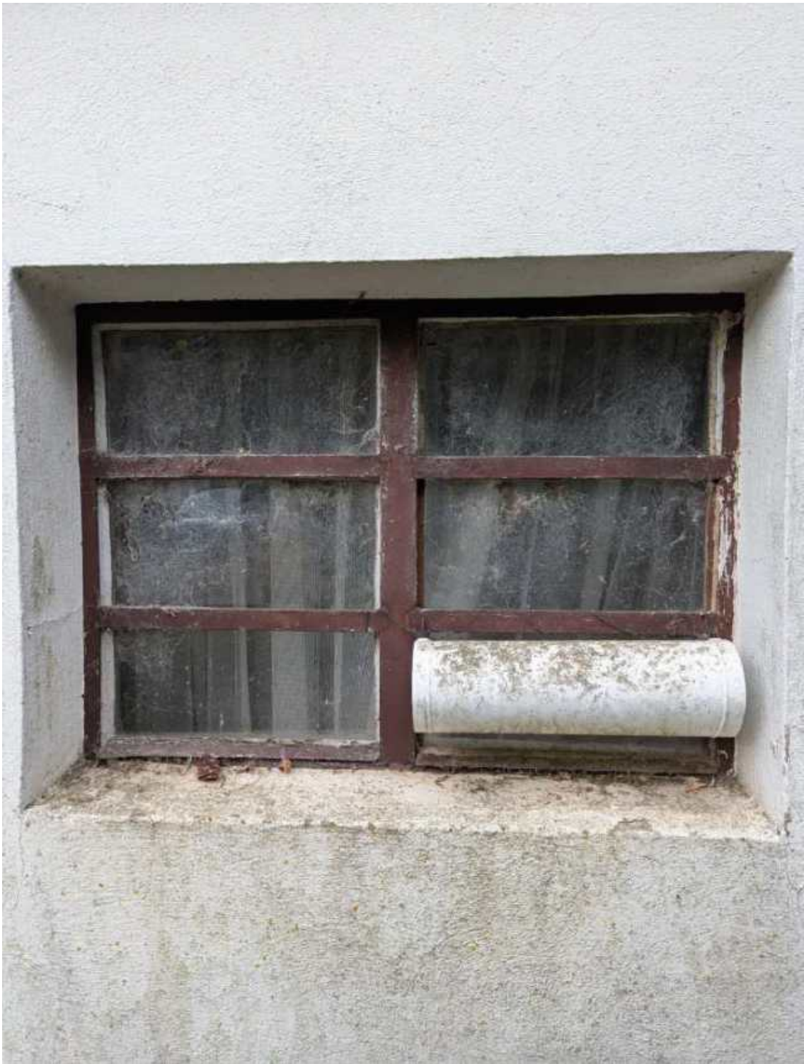
Lfd. Nr. 1 Wohnhaus Kellerfenster
