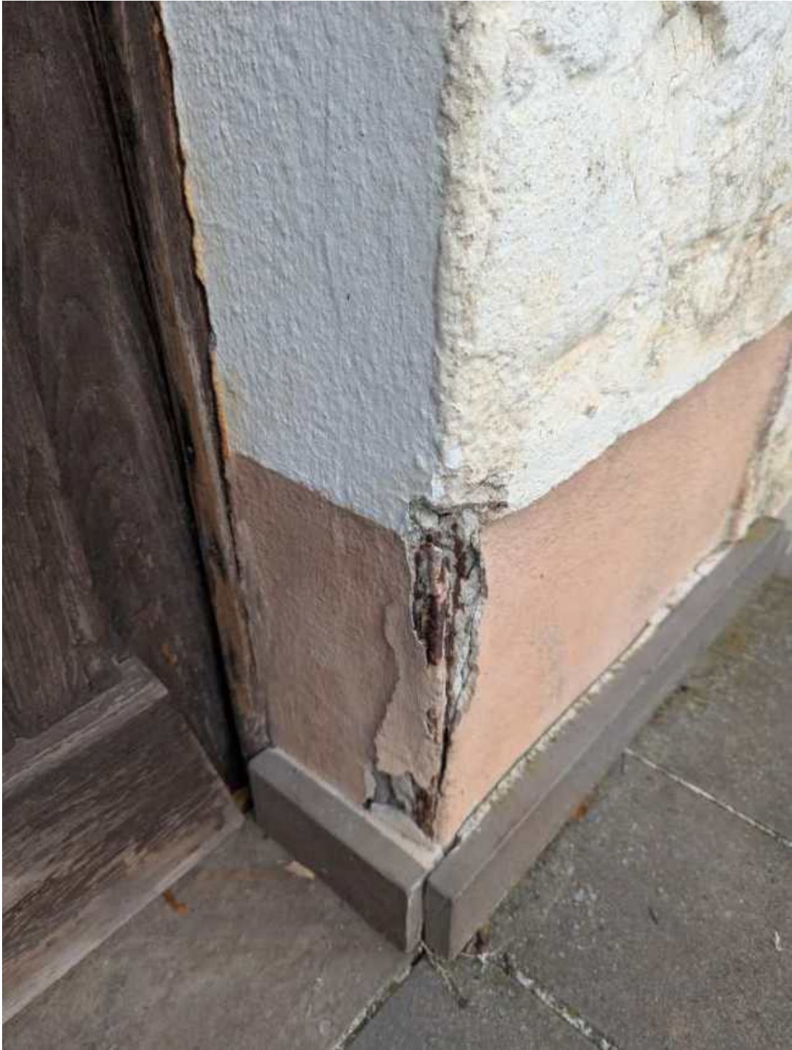
Lfd. Nr. 1 Wohnhaus Schäden am Außenputz
