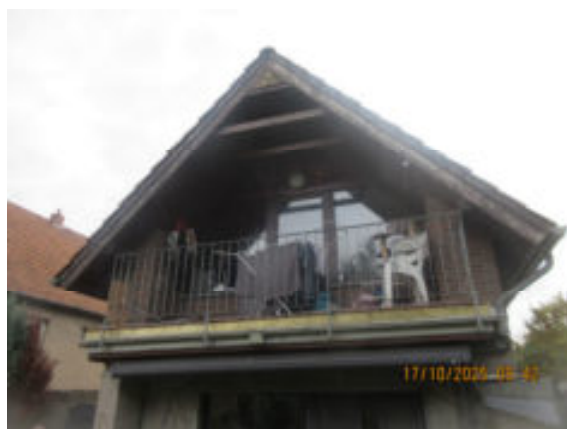
Balkon vom Anbau/ Anstrichschäden an der Holzkonstruktion des Daches (Witterungseinflüsse)
