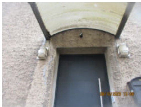
Eingangsüberdachung mit Rissbildungen im Putz
