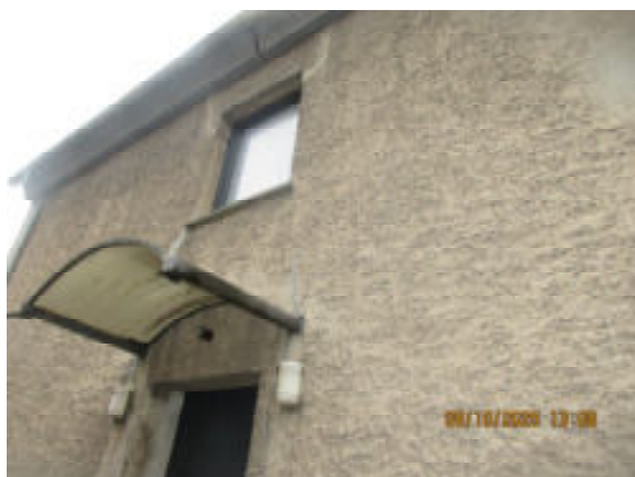
Risse im Außenputz
