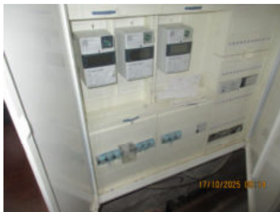
Zählerkasten im Keller
