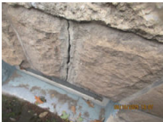
Riss im Sockelmauerwerk
