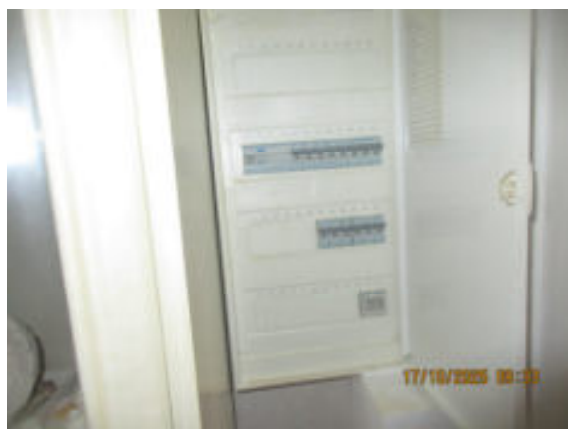
Unterverteilung im Dachboden
