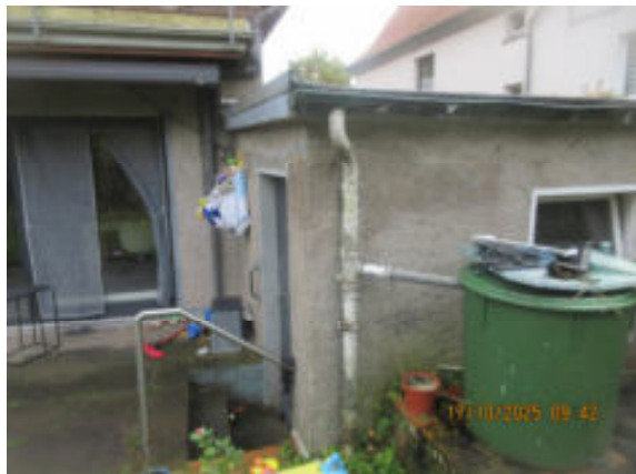
Schadhaftes Fallrohr und Putzrisse
