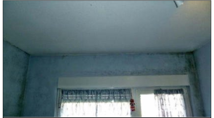
-10- Stock- und Schimmelbefall OG
