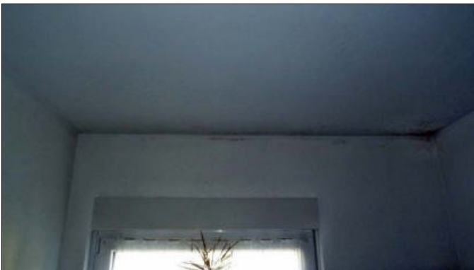
-11- Stock- und Schimmelbefall OG
