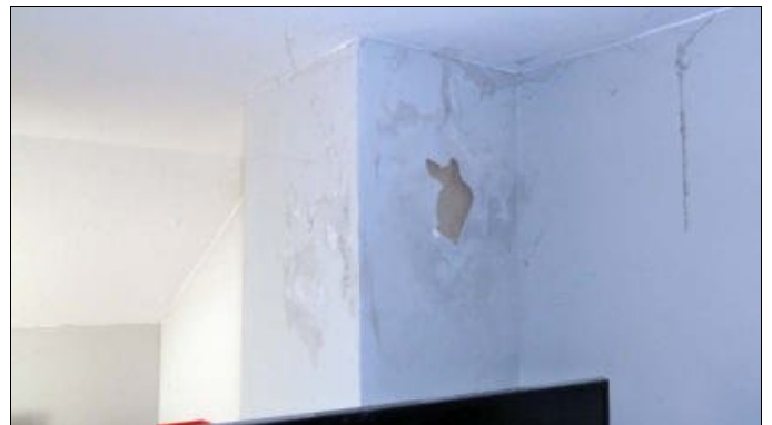
-12- Putzablösung am Schornstein DG
