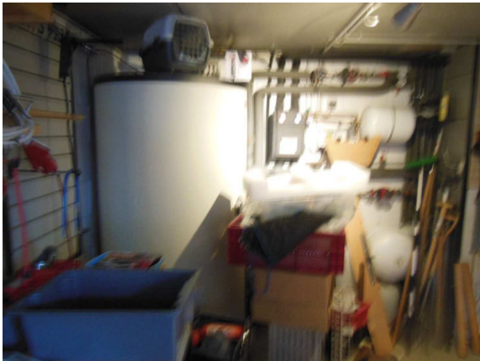
Heiztechnik und Wasserspeicher
