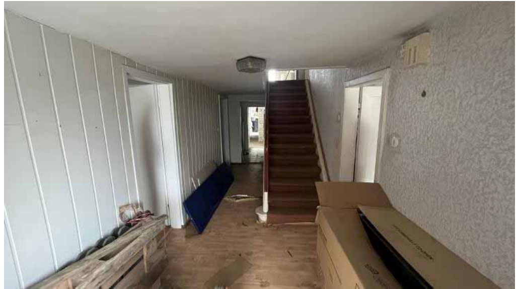
EG: „Arbeitszimmer“ (Sperrmüll im gesamten Gebäude)
