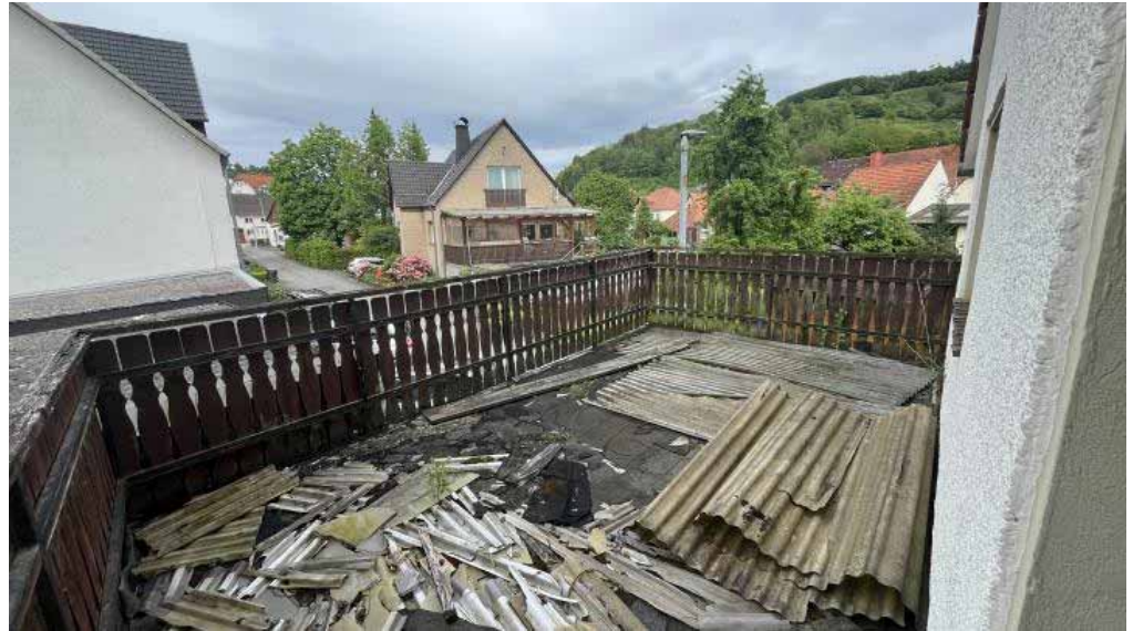
OG: „Dachterrasse“: auf Garagenanbau (marode)
