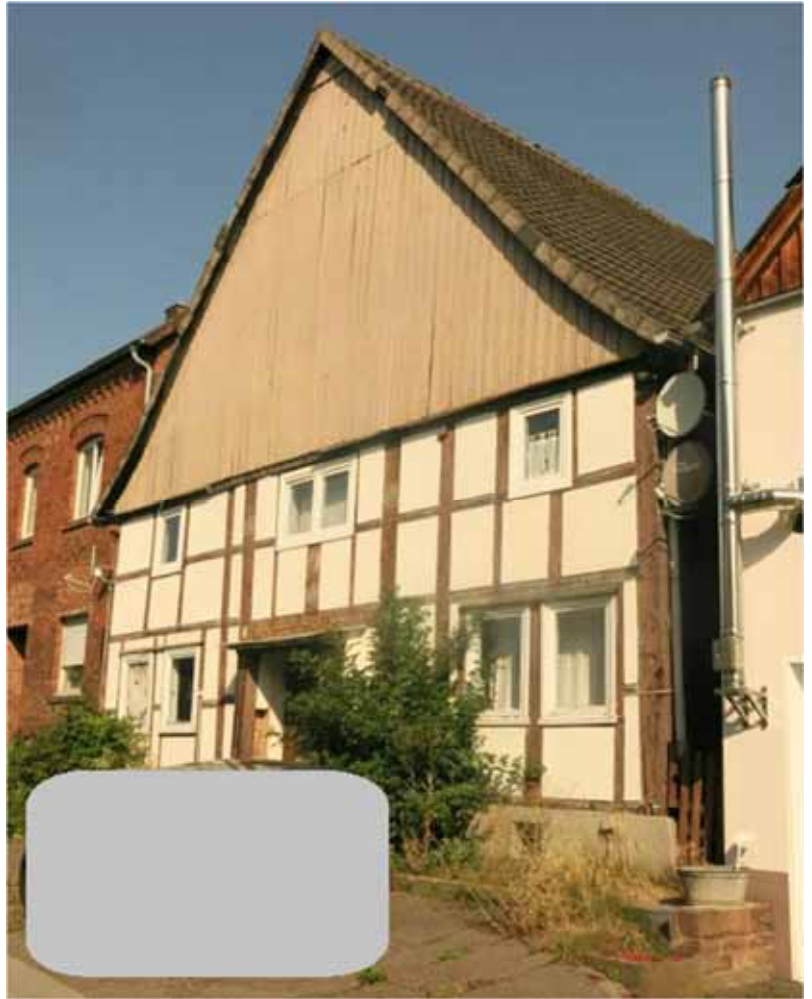
Obere Reihe 12, Schäden an Fachwerk, Dach, Entwässerung
