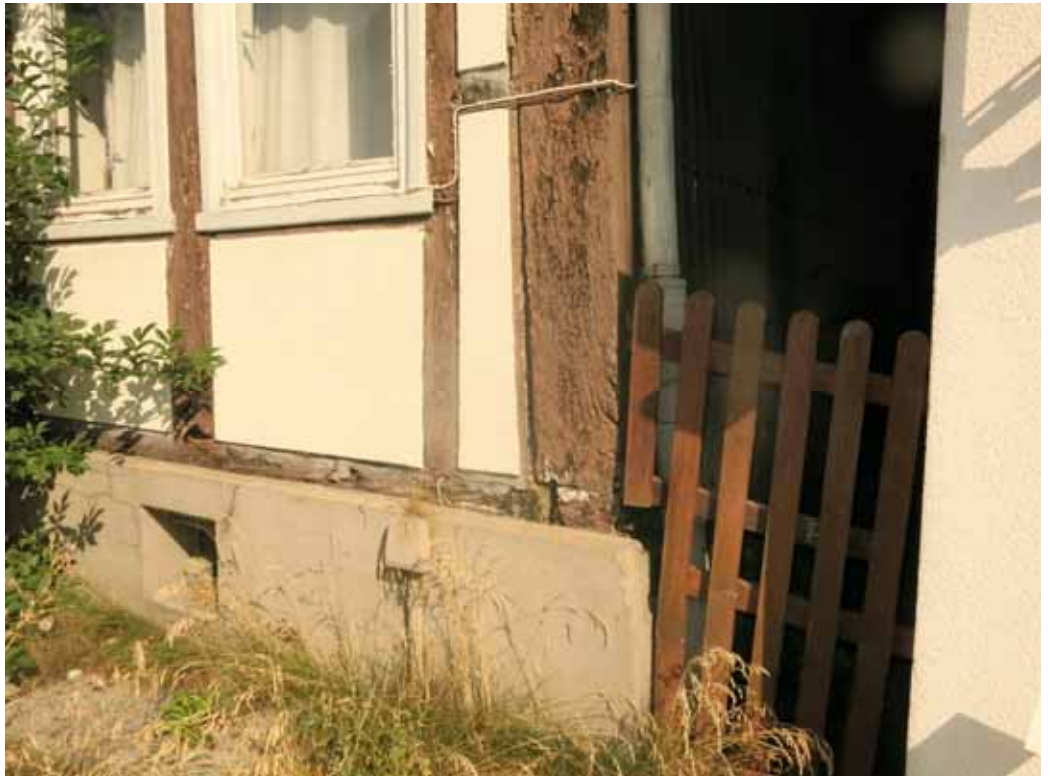
Obere Reihe 12, starke Schäden an Fachwerk (Schwelle und Eck-Stiel marode)
