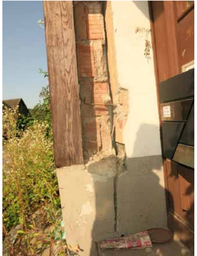
Obere Reihe 12, Schäden an Fachwerk, Mauerwerk mit starken Setzrissen
