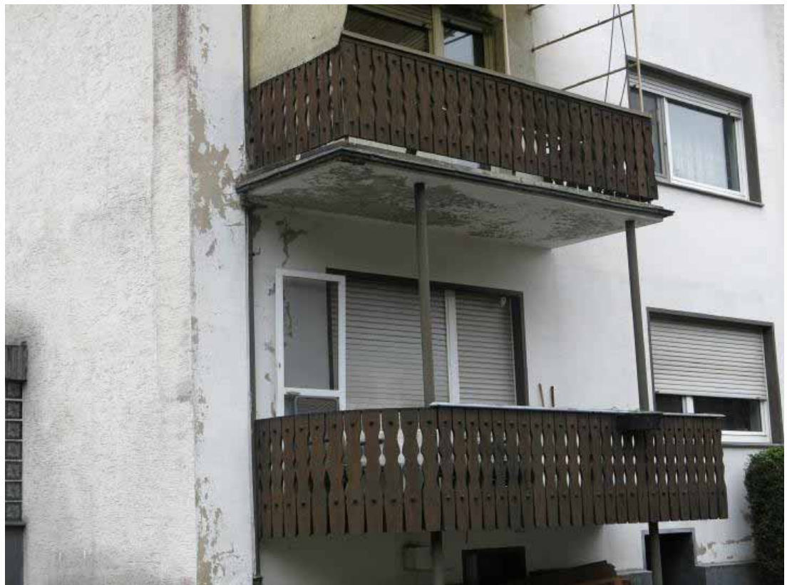
Obere Hauptstraße 217 - 219; Feuchteschäden an Fassaden und Balkonen
