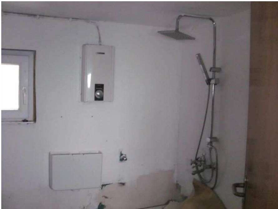
Duschbereich im Badezimmer
