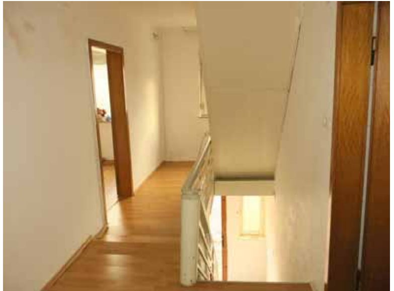
Beispiel A) Whg. 2 im DG; Treppenflur (Fußboden „schüsselt“ auf)
