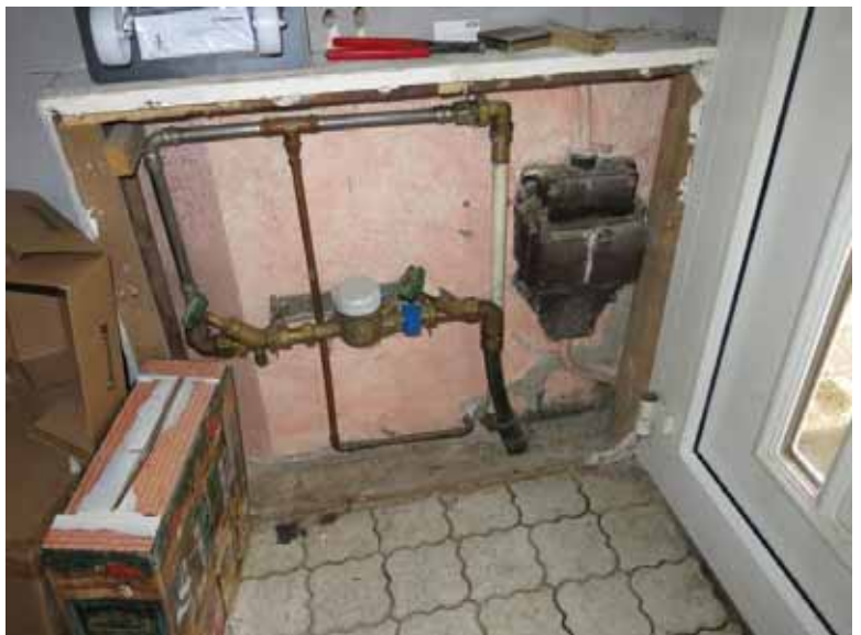
Beispiel Haustechnik veraltet: Wasser- und Stromanschluss im EG
