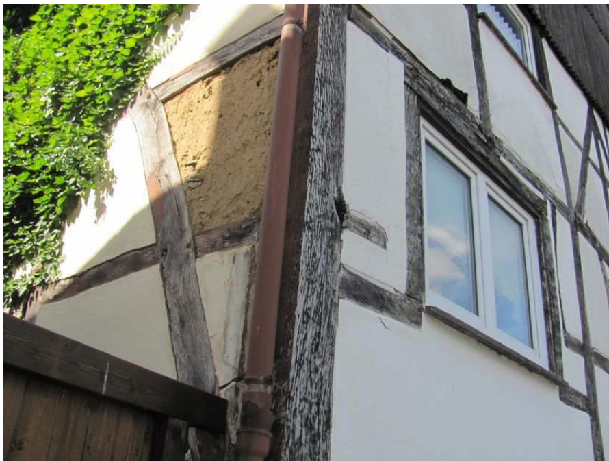
Fehlstellen der Putzgefache
