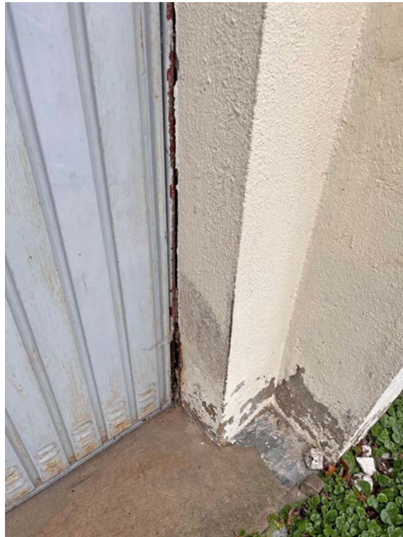
Feuchtigkeitsschäden an der Garage
