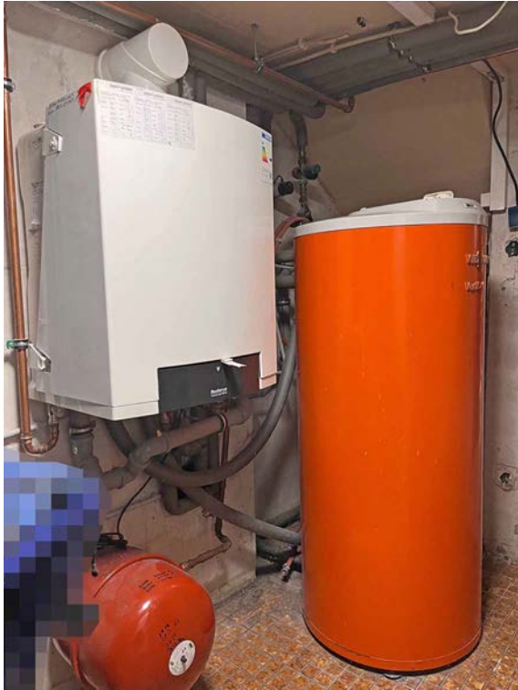
Heizungsanlage mit Warmwasserspeicher
