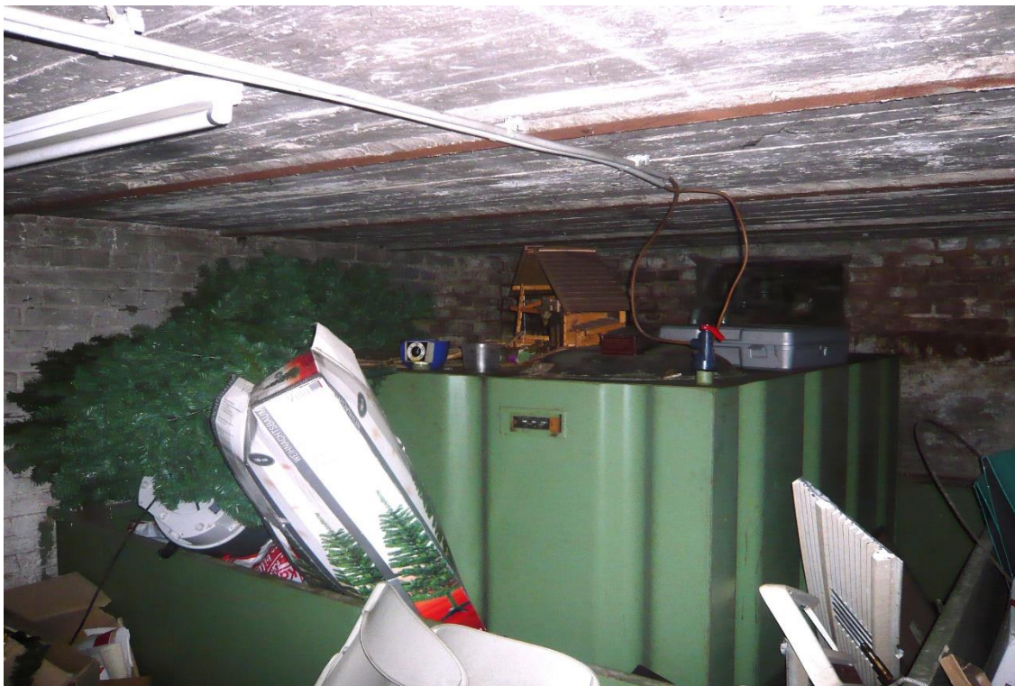
Öltanks im Heizungsraum
