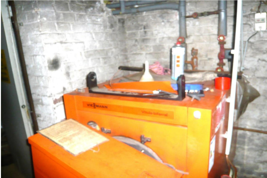
Heizkessel im Heizungsraum
