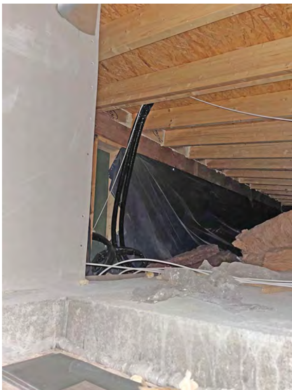
Speicherraum Staffelgeschoss, verschobene Dämmung, abgerissene Folie
