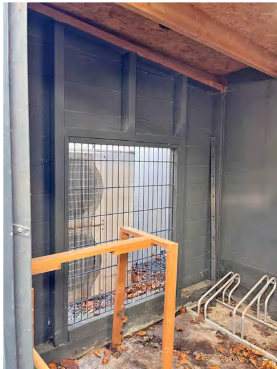
marode Sockelbalken im hinteren Fahrradschuppen
