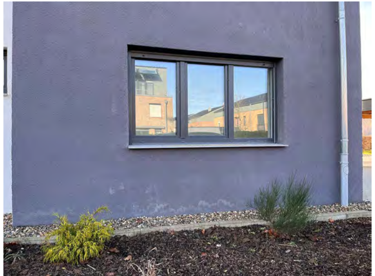
Feuchtigkeitsschäden im Sockelbereich des WDVS (exemplarisch)
