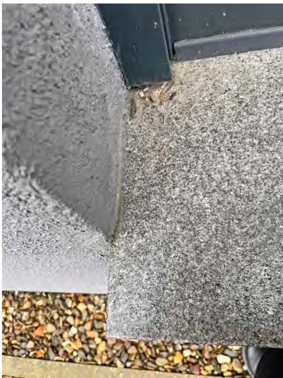
mangelhafte Putzüberdeckung im Bereich der Natursteinfensterbank (exemplarisch)
