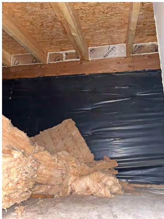
Speicherraum Staffelgeschoss, verschobene Dämmung
