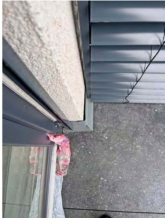
mangelhafter Sockelanschluss (exemplarisch)
