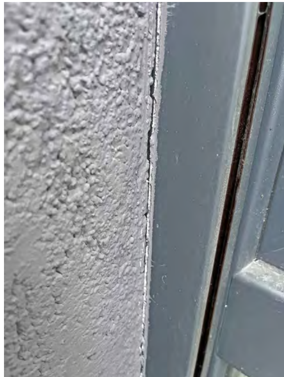
Flankenabriss des Putzes an den Fenstern
