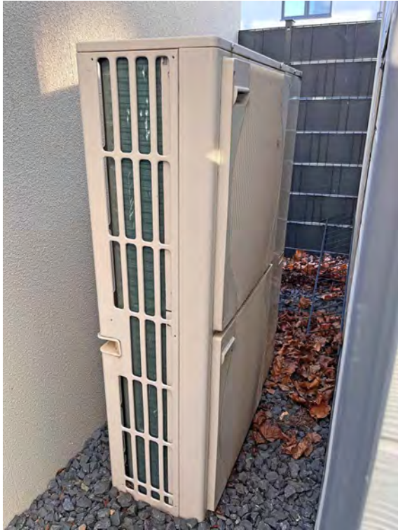
Wärmepumpe zwischen den Fahrradschuppen
