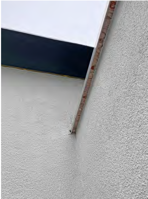
mangelhafter Anschluss der Attika-Abdeckung an die Außenwand (exemplarisch)
