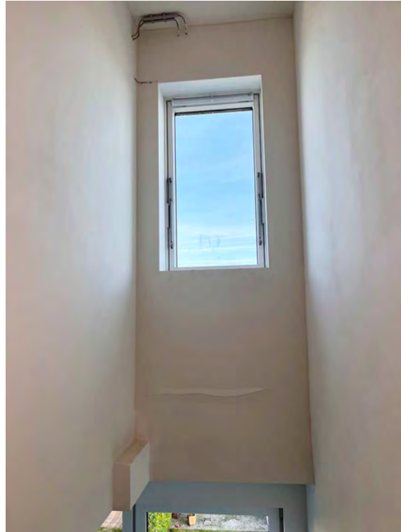
Rissbildung im Putz (Treppenhaus Staffelgeschoss)
