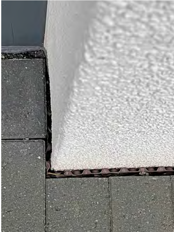
mangelhafte Sockelausbildung des WDVS
