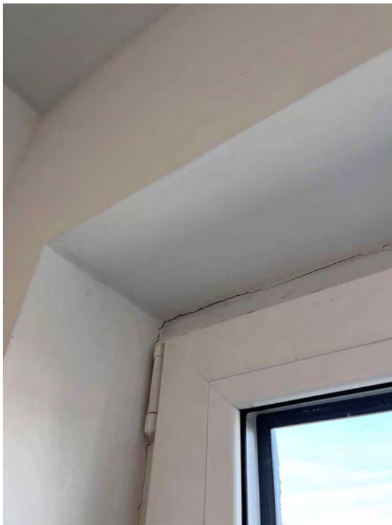
Flankenabriss Putz/Fenster im Leibungsbereich innen (exemplarisch)
