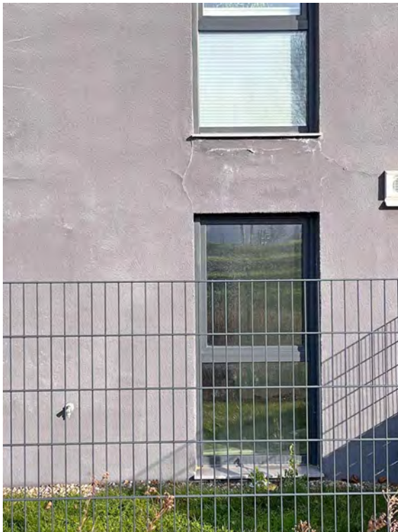
Detailansicht Schäden am WDVS
