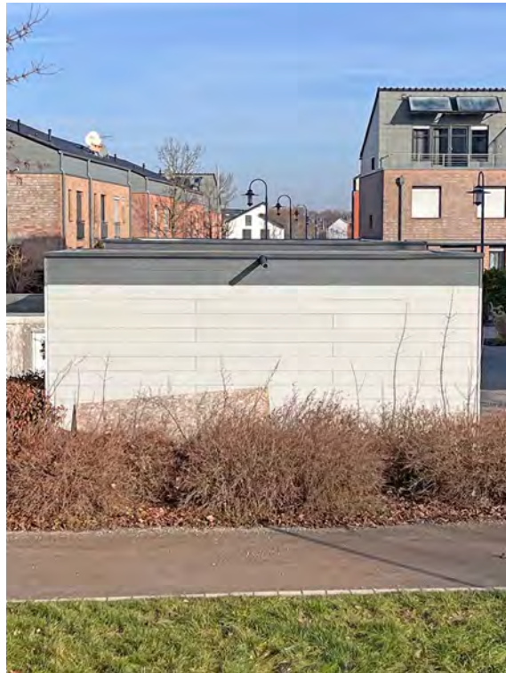
Abstellräume, Ansicht von Südwesten mit freier Entwässerung auf das angrenzende Grundstück (Anna-Park)
