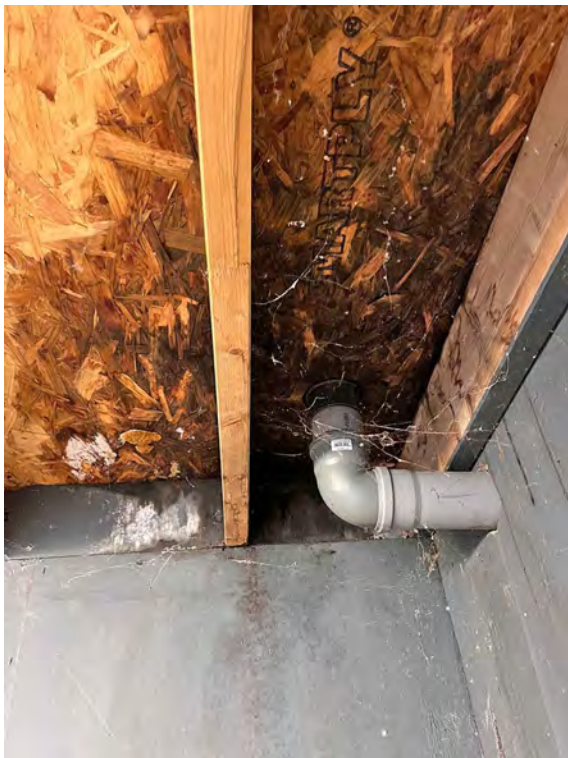
Feuchtigkeitsschäden am Dach des hinteren Fahrradschuppens
