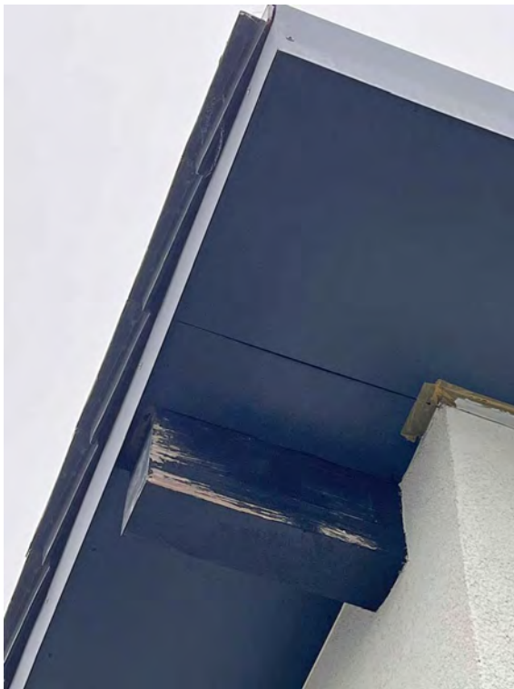
ungeschützte, abgewitterte Balkenköpfe des Pultdachs
