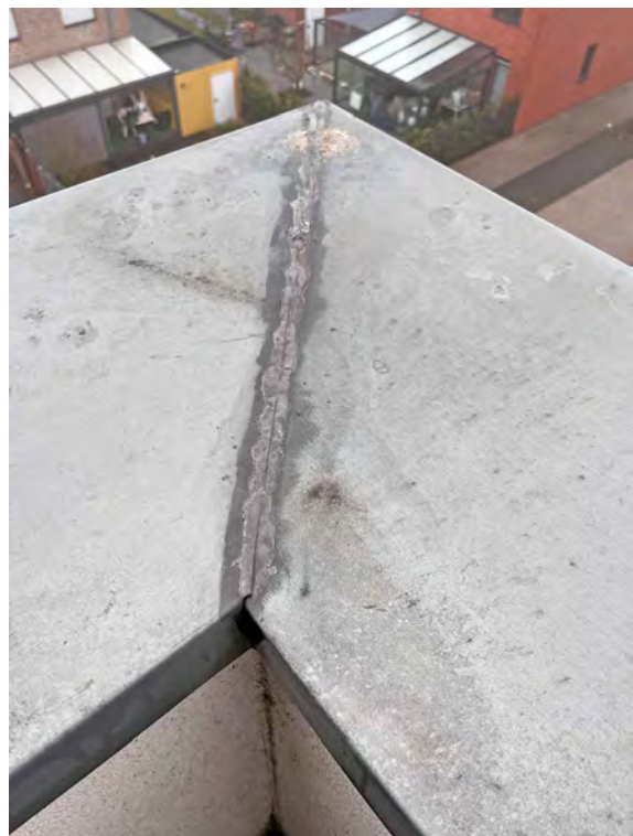
mangelhafte Ausbildung der Eckverbindung bei der Brüstungsabdeckung im Staffelgeschoss (exemplarisch)
