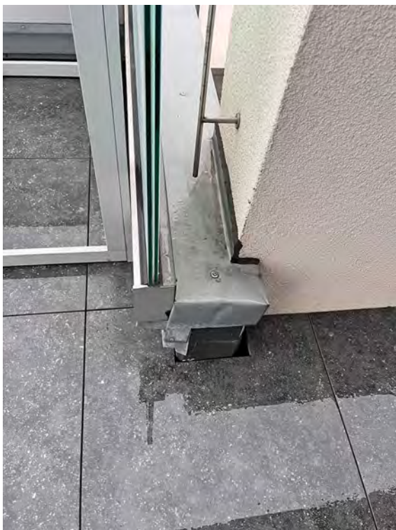
mangelhafte Ausführung der Brüstungsabdeckung im Staffelgeschoss (exemplarisch)
