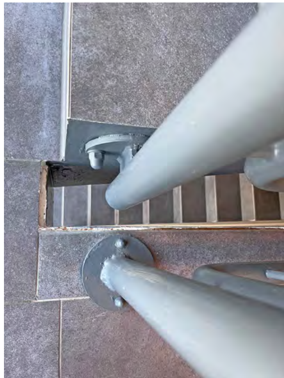
unsaubere Ausführung Treppenaug und Anstrich Geländer (exemplarisch)
