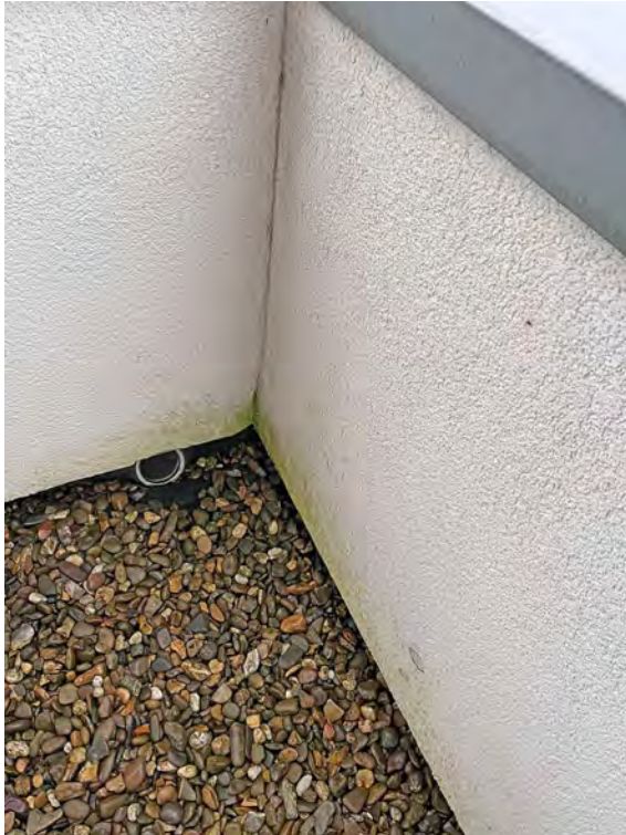
mangelhafte Entwässerung der Dachterrasse
