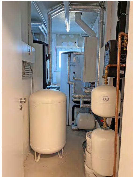
Technikraum im Staffelgeschoss
