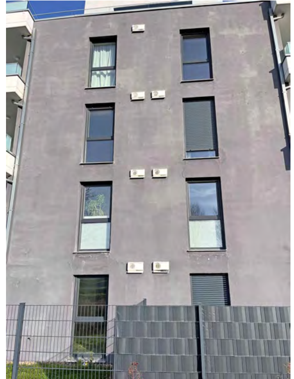
Teilansicht von Südwesten mit Rissbildung im WDVS
