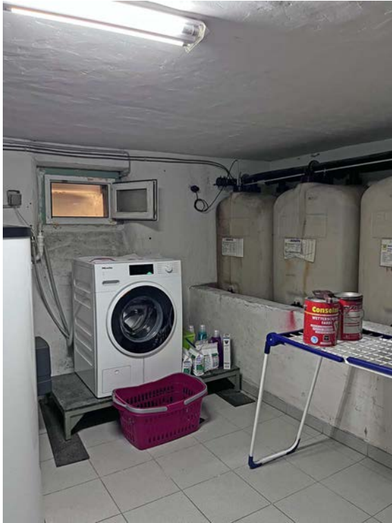
Heizungskeller mit Waschmaschine und Öltanks
