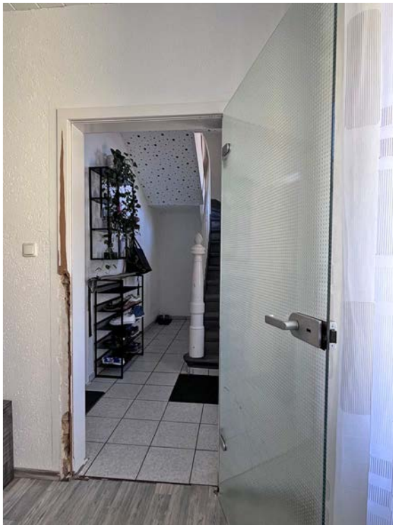
Zimmer vorne mit beschädigter Türzarge
