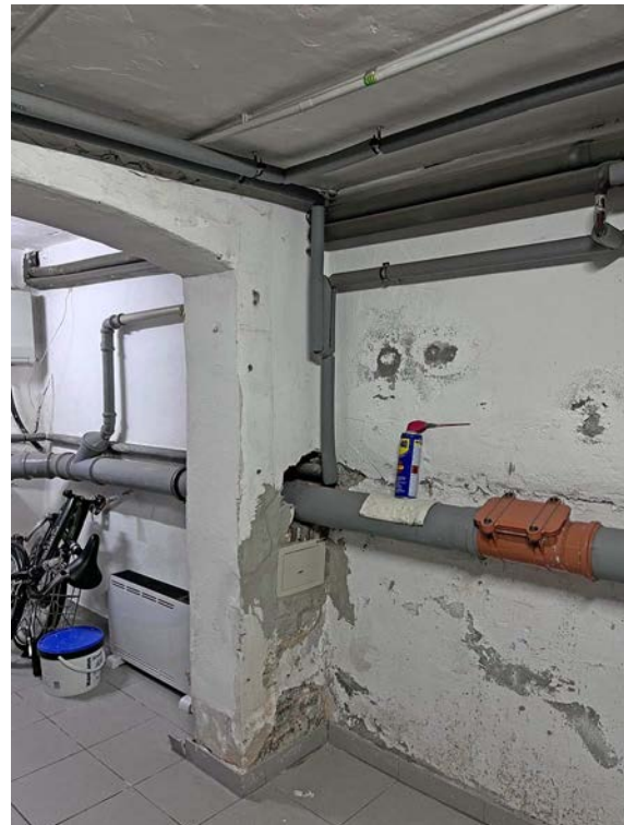
Heizungskeller mit Feuchtigkeitsschäden
