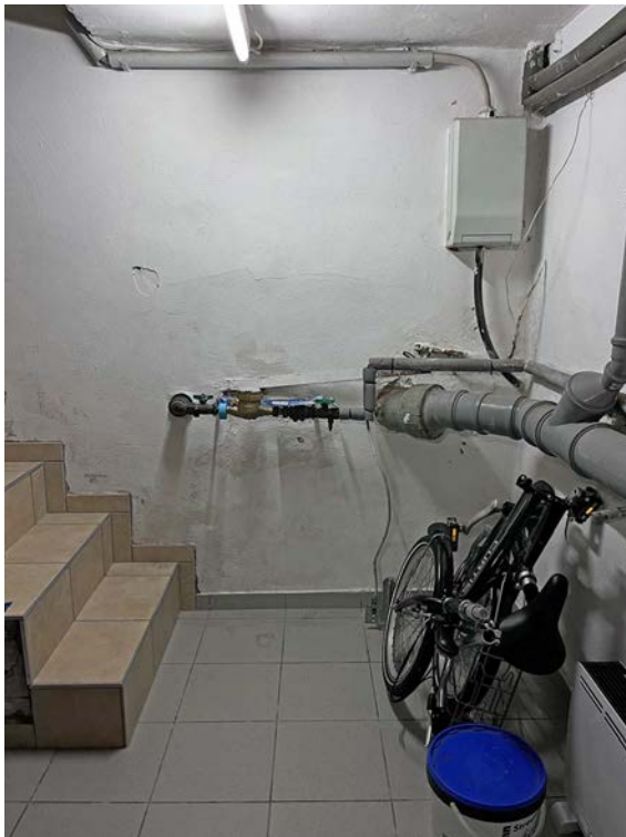
Kellerflur mit Hausanschlüssen
