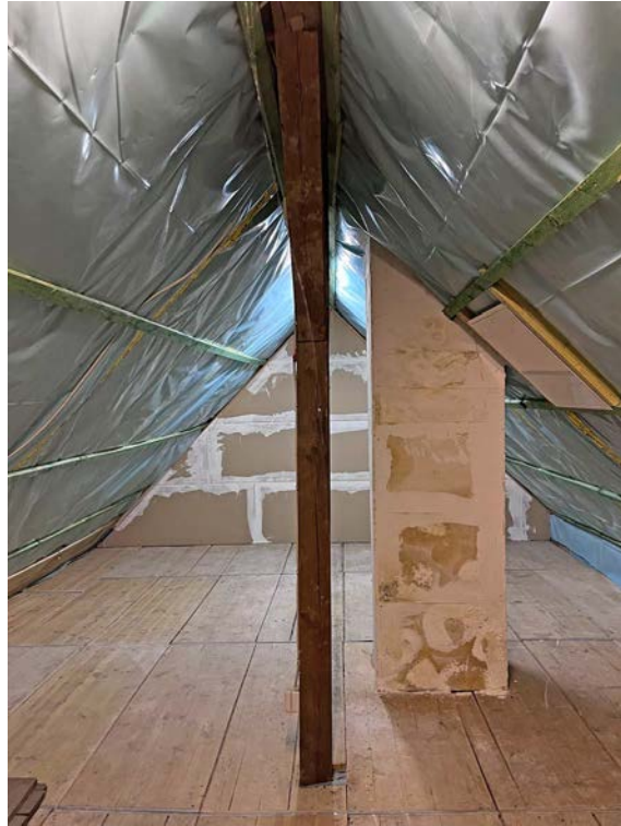
Spitzboden mit Feuchtigkeitsschäden am Kamin
