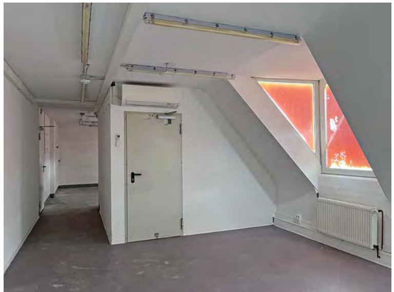
Personalraum DG, vorne mit Zugang zur Lüftungszentrale
