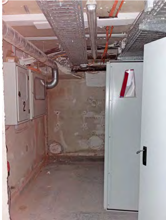
Elektro-Zentrale mit Stromzählern
