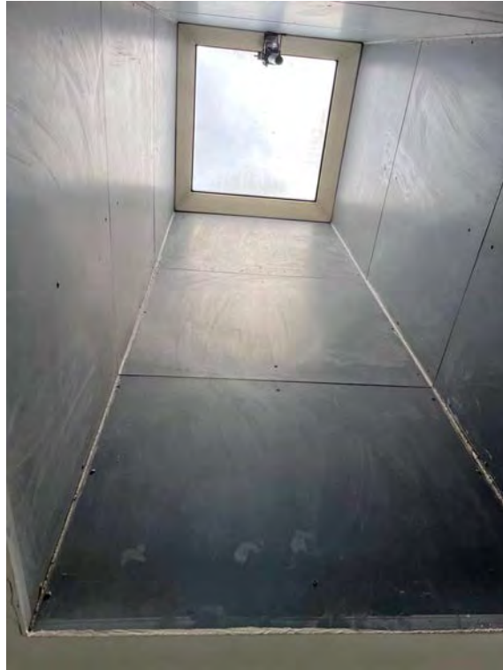
RWA, Treppenhaus DG
