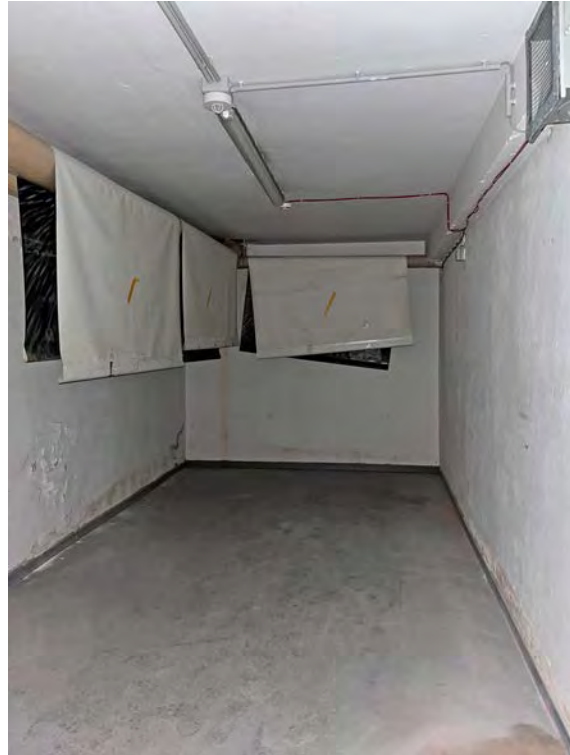
Kellerraum 2 mit Feuchtigkeitsschäden
