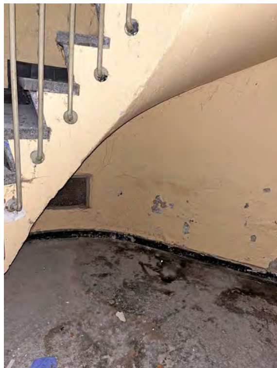
Feuchtigkeitsschäden im KG unter der Treppe
