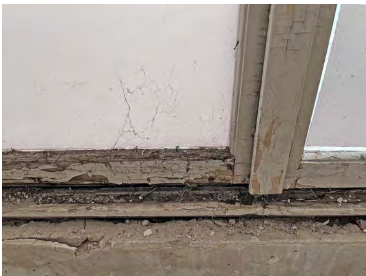
marode Holzfenster mit Einfachverglasung im 1. OG hinten
