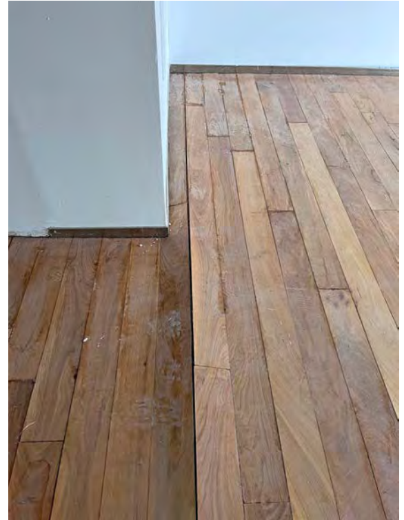
Wasserschaden im 1. OG
