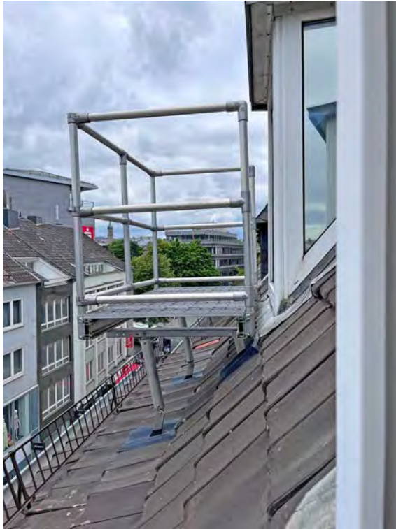
Austritt Büroraum DG
