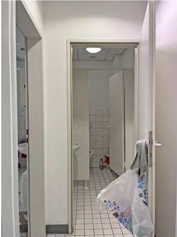
WC-Anlage im 1. OG
