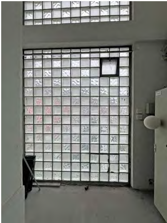
Serverraum im 2. OG hinten rechts
