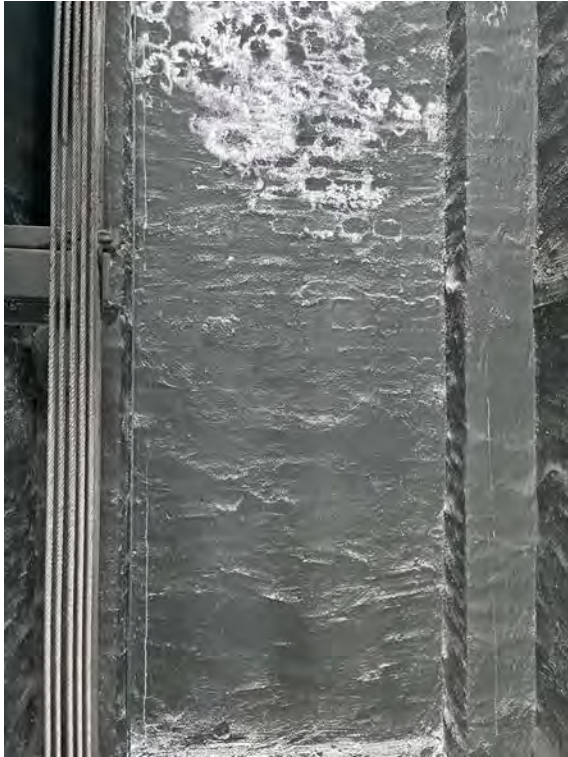
Feuchtigkeitsschäden Aufzugsschacht (2. OG)
