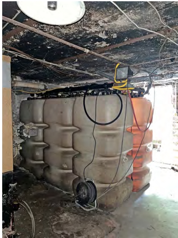
Öltanks im Heizungskeller
