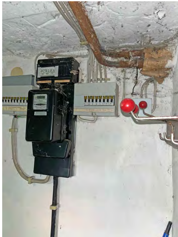
Elektroinstallation im Kellergeschoss
