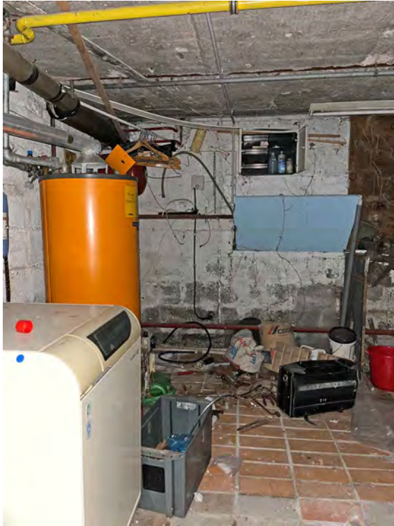
Heizungsraum im Kellergeschoss
