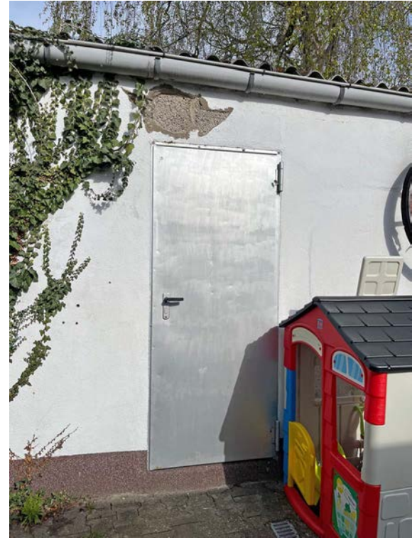
Schuppen I mit seitlicher Ausgangstür und Putzabplatzungen
