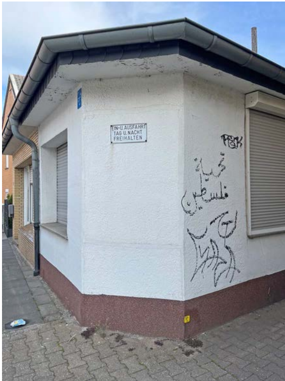
auf Flst. 623 überbaute Gebäudeecke mit abplatzendem Anstrich des Dachüberstandes
