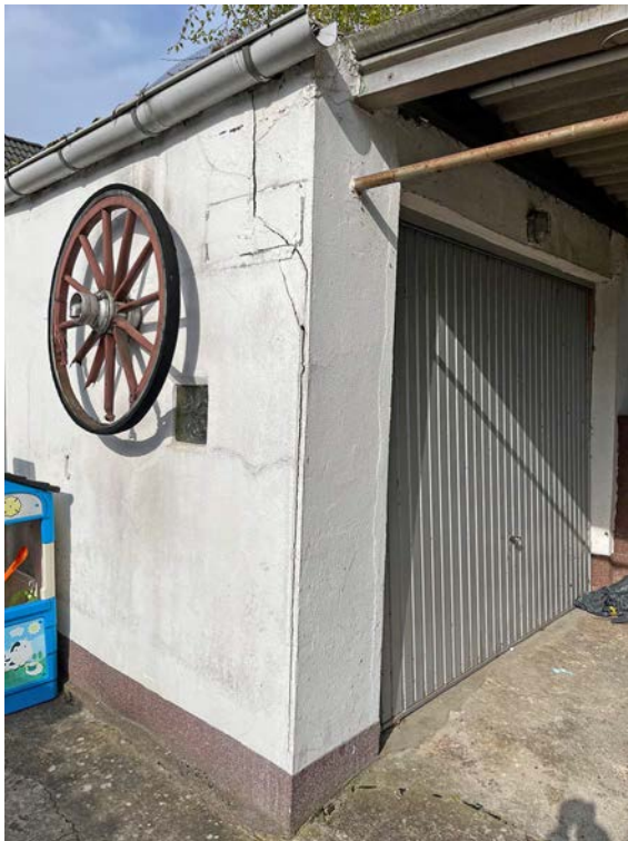
Schuppen I mit Rissbildung im Eckbereich
