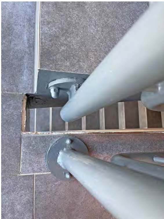
unsaubere Ausführung Treppenauge und Anstrich Geländer (exemplarisch)
