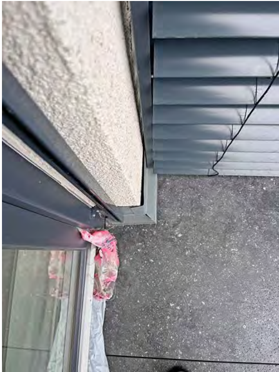
mangelhafter Sockelanschluss (exemplarisch)
