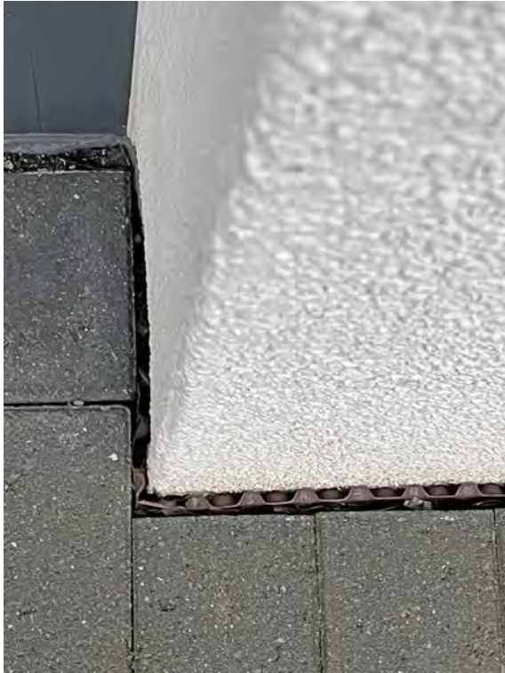
mangelhafte Sockelausbildung des WDVS
