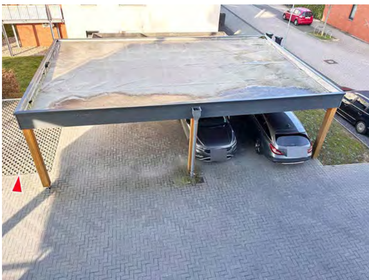
Stellplatz P5, Foliendach Carport, Falten- und Pfützenbildung, vermutlich Beschädigungen im Eckbereich
