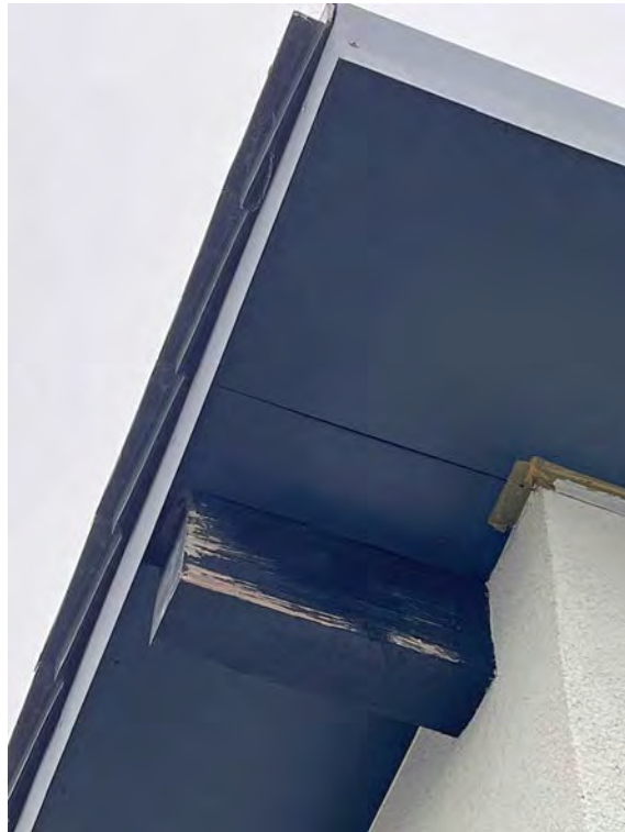
ungeschützte Balkenköpfe des Pultdachs
