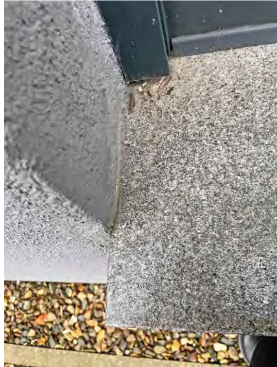
mangelhafte Putzüberdeckung im Bereich der Natursteinfensterbank (exemplarisch)
