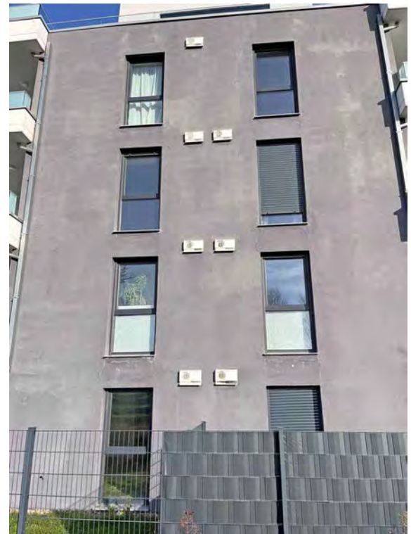
Teilansicht von Südwesten mit Rissbildung im WDVS
