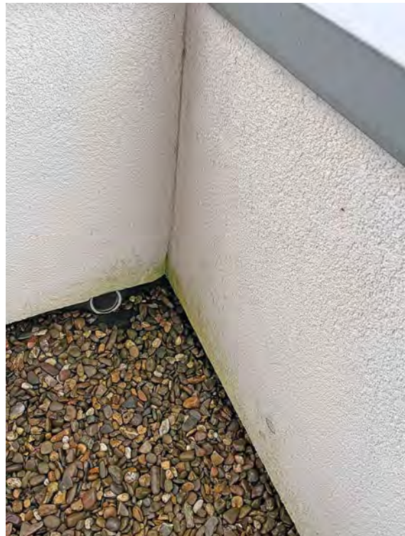
mangelhafte Entwässerung der Dachterrasse
