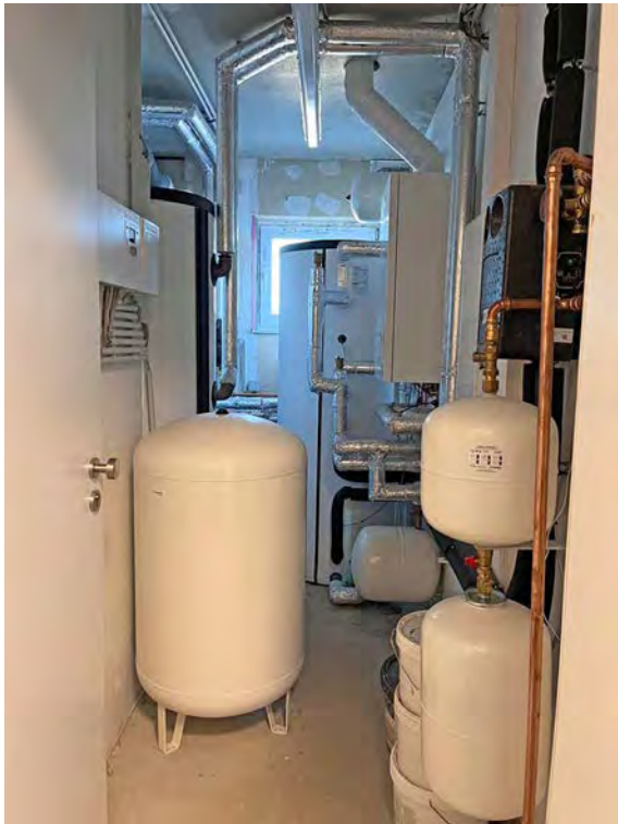
Technikraum im Staffelgeschoss
