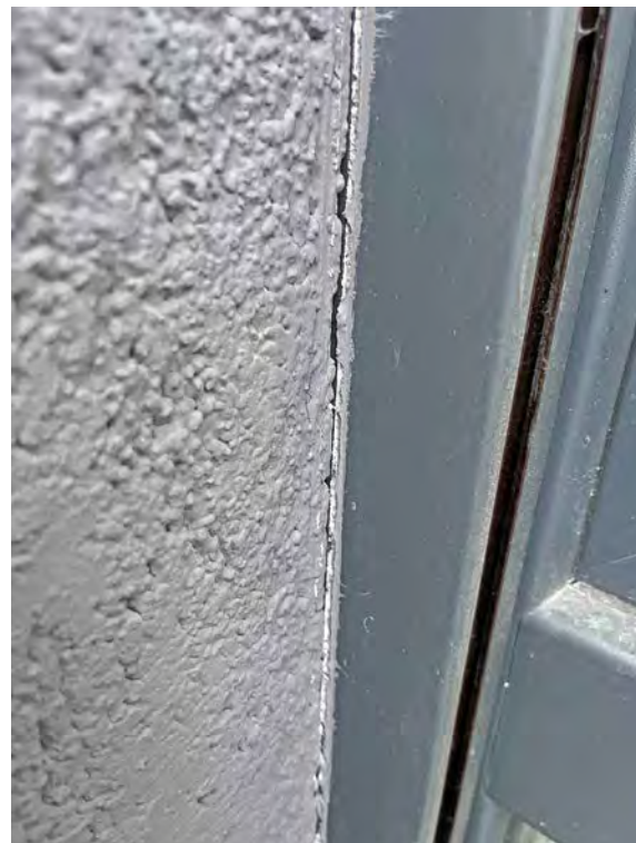
Flankenabriss des Putzes an den Fenstern
