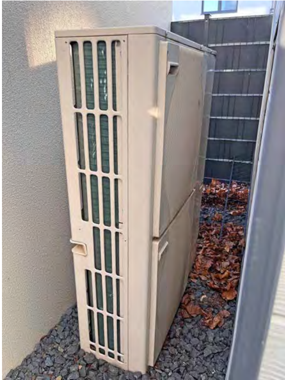
Wärmepumpe zwischen den Fahrradschuppen
