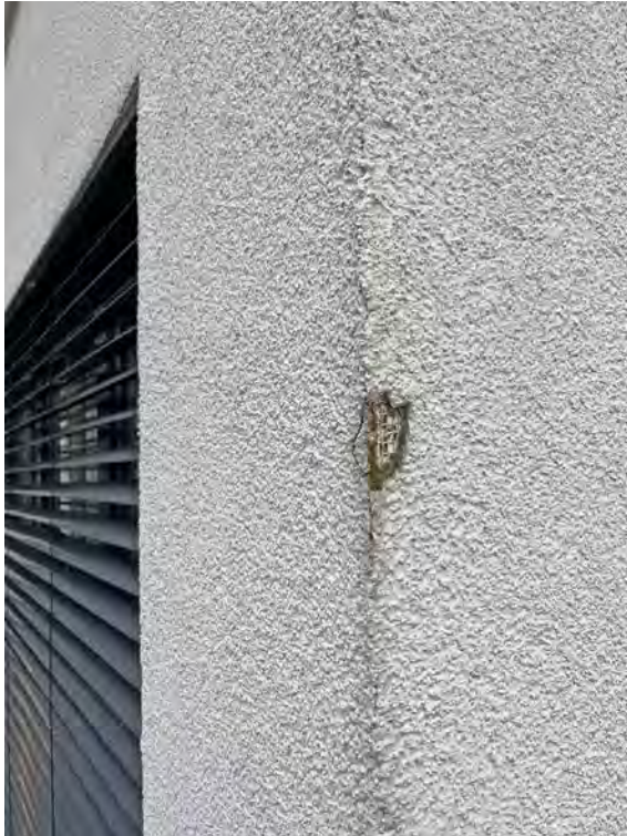
Beschädigung im WDVS
