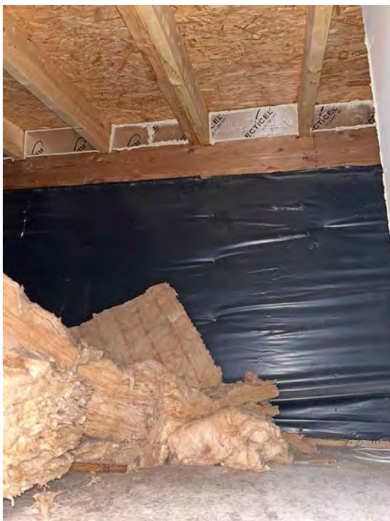
Speicherraum Staffelgeschoss, verschobene Dämmung
