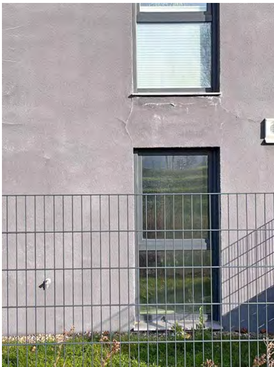
Detailansicht Schäden am WDVS
