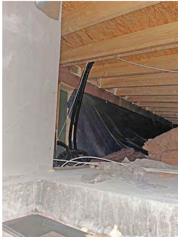
Speicherraum Staffelgeschoss, verschobene Dämmung, abgerissene Folie
