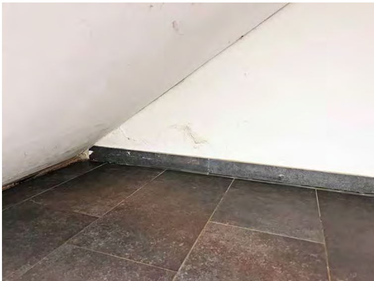
Feuchtigkeitsschäden unter der Treppe im Erdgeschoss
