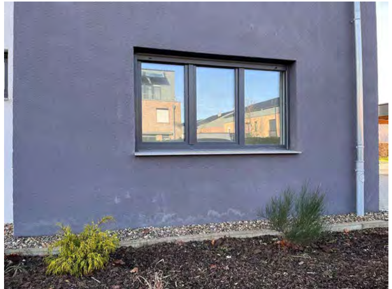
Feuchtigkeitsschäden im Sockelbereich des WDVS (exemplarisch)
