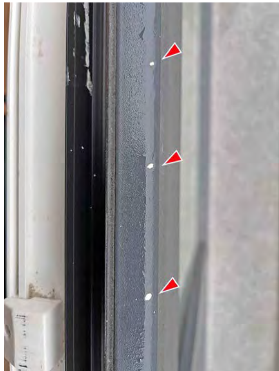
Fehlstellen in der Folierung der Fenster (exemplarisch)
