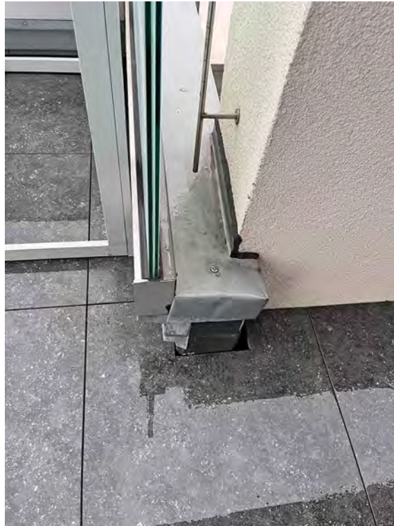
mangelhafte Ausführung der Brüstungsabdeckung im Staffelgeschoss (exemplarisch)
