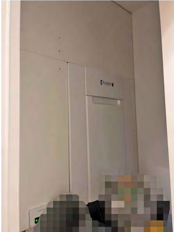
Lüftungsanlage im Abstellraum
