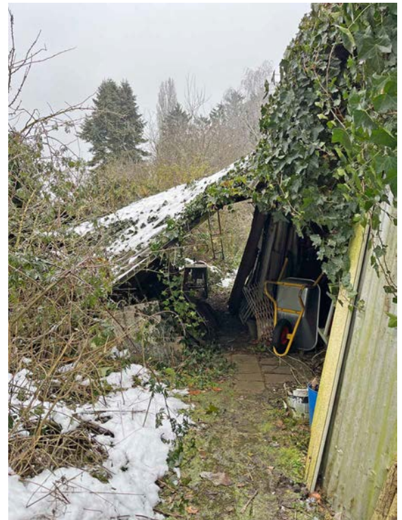
maroder Holzverschlag hinter dem Schuppen
