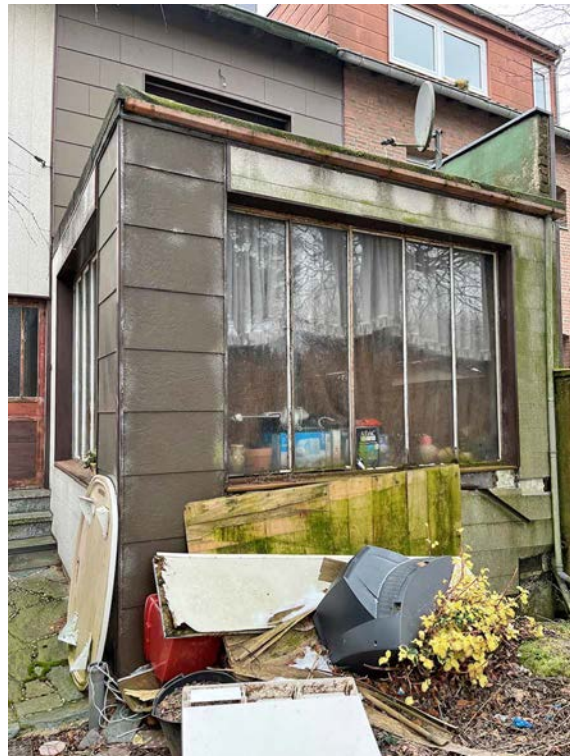
Anbau mit Sperrmüll
