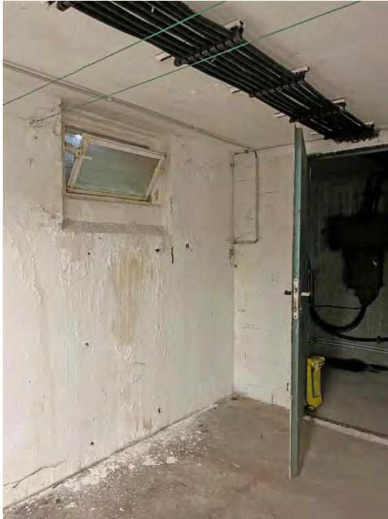
Kellerraum mit Feuchtigkeitsschäden
