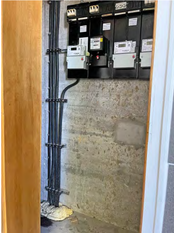
Zählerraum Strom (exemplarisch)
