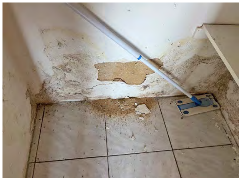
Feuchtigkeitsschaden im Abstellraum
