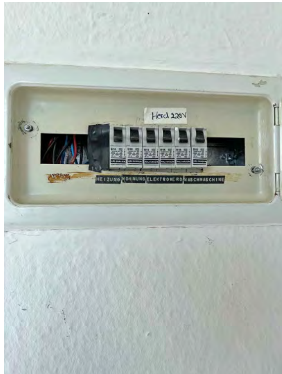
Unterverteilung im Flur
