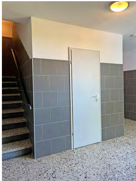
Treppenhaus mit Zählerraum Strom
