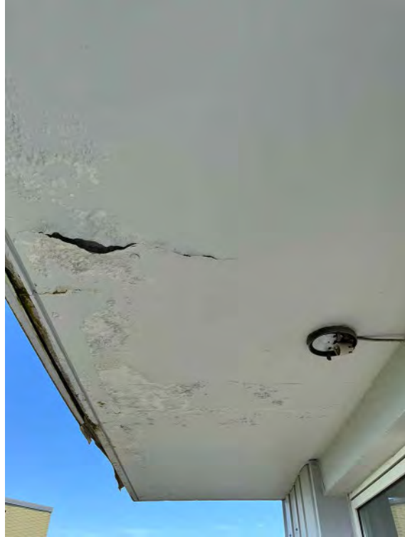
Feuchtigkeitsschäden an Balkonplatte 6. OG (exemplarisch)
