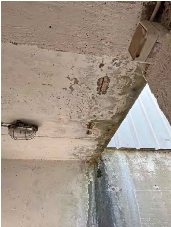
Vordach über Kelleraußentreppe mit Schäden
