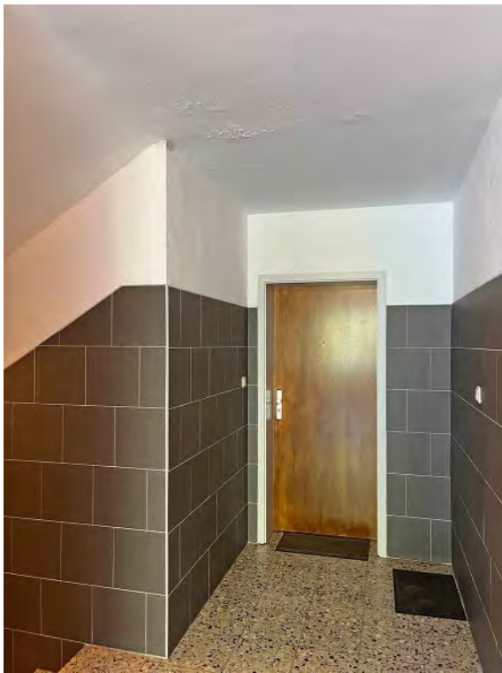
Flur im 7. OG mit Feuchtigkeitsschäden an der Decke
