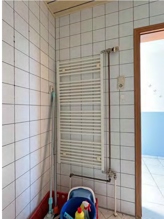
Heizkörper im Bad
