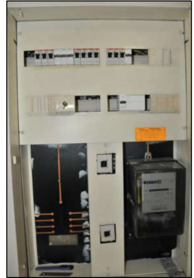
Sicherungskasten im Treppenhaus
