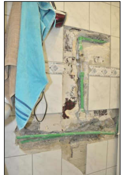
Wasserschaden über dem Waschbecken
