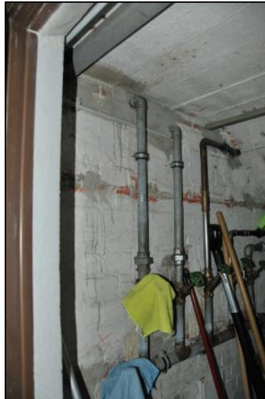
Hausanschlüsse unter der Treppe
