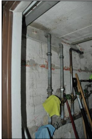
Hausanschlüsse unter der Treppe
