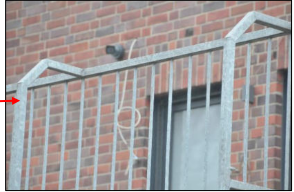
Terrassengeländer, Kamera und Strom Außenbeleuchtung
