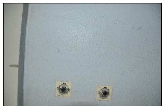
Defekte Lichtschalter im Flur Friedenstraße
