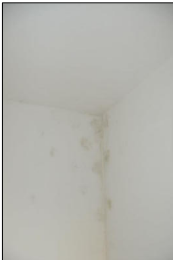
Anzeichen von Feuchtigkeit, Treppenhaus 1. OG Anbau
