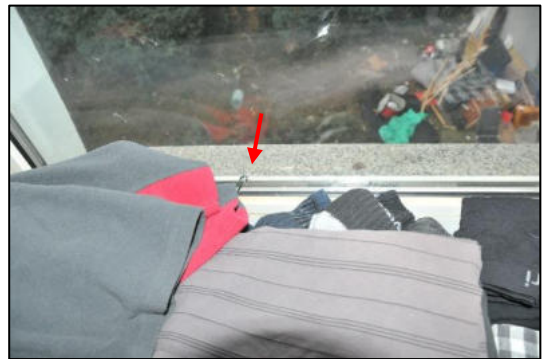
gerissene Scheibe Wohnzimmer
