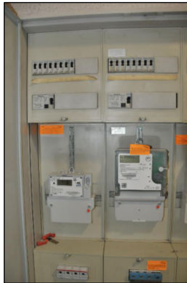
Zählerkasten im Treppenhaus
