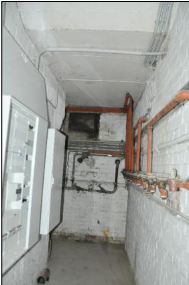
Kellergang mit Hausanschlüssen
