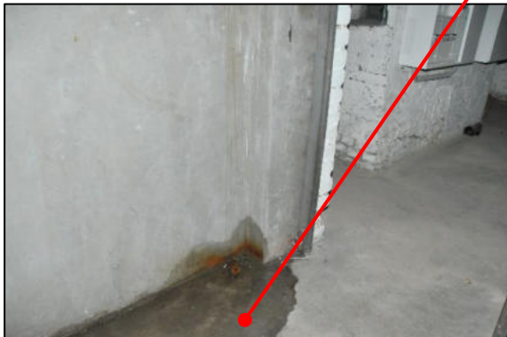
Wassereintritt Kellerwand Trockenraum
