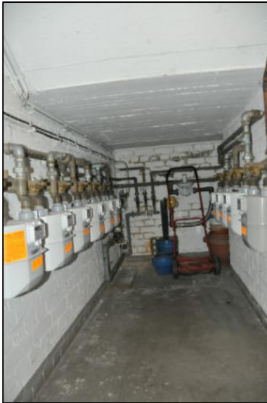
Hausanschlüsse Gas und Wasser
