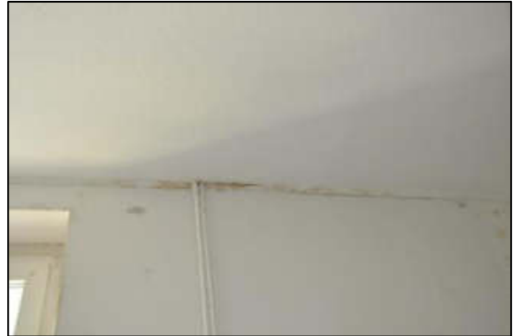
Wasserschaden und Heizkörperleitung
