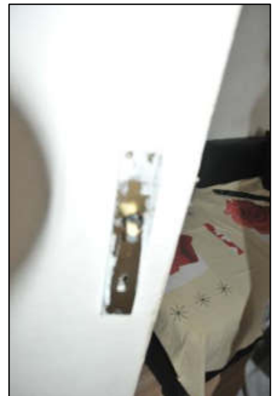
Türbeschlag / fehlende Klinke
