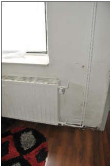
Heizkörper und Leitungen
