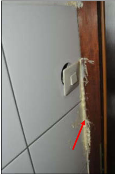
Badezimmerzarge und Lichtschalter
