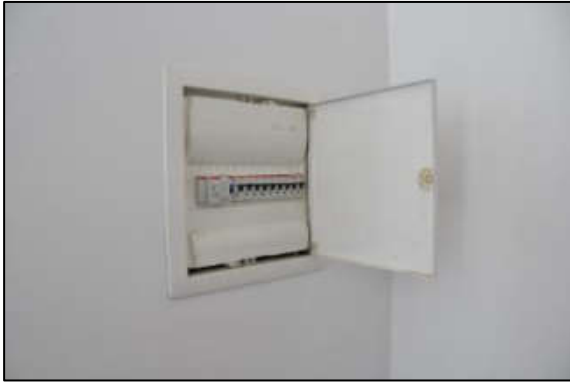
Sicherungskasten im Wohnbereich
