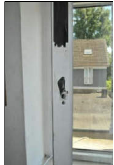
defektes Fenster / fehlender Griff
