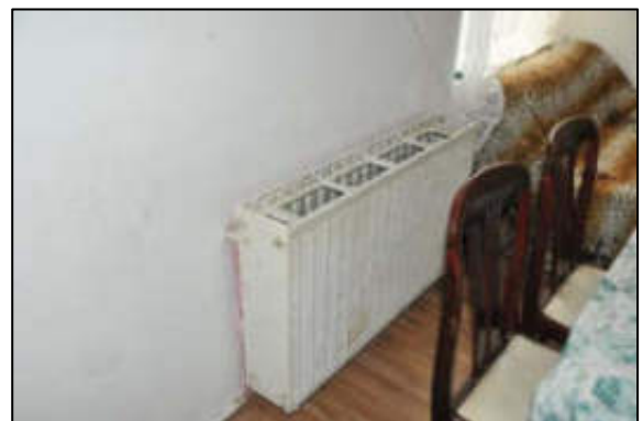
ein typischer Heizkörper im Vorderhaus
