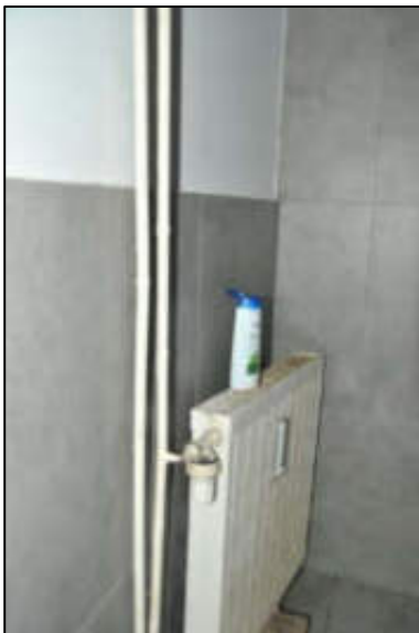
Heizkörperleitungen auf Putz
