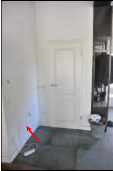
Gäste WC, links Verteiler Fußbodenheizung
