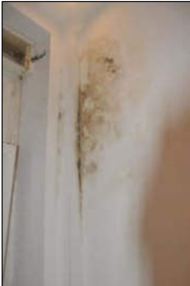
Feuchtigkeit Innenwand Erdgeschoss auf Höhe Balkone
