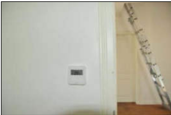
Raumthermostat, im Hintergrund Leiter zum Dachgeschoss
