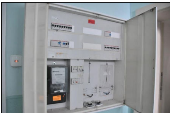
Sicherungskasten im Treppenhaus
