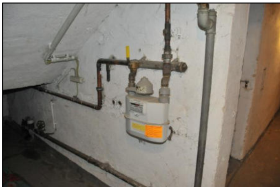
Hausanschlussbereich unter der Kellertreppe
