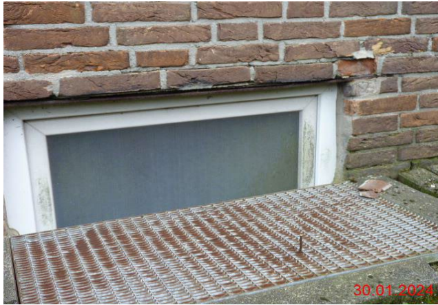
Abb. 7 zu erneuernde Metallstürze Kellerfenster
