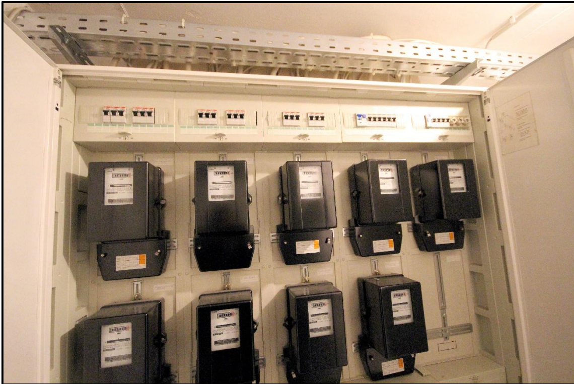
Bild 15: Zählerschrank im Kellerflur
