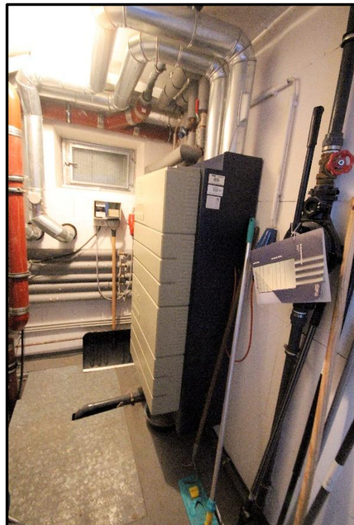
Bild 14: Heizungskeller mit der Fernwärme-Übergabestation
