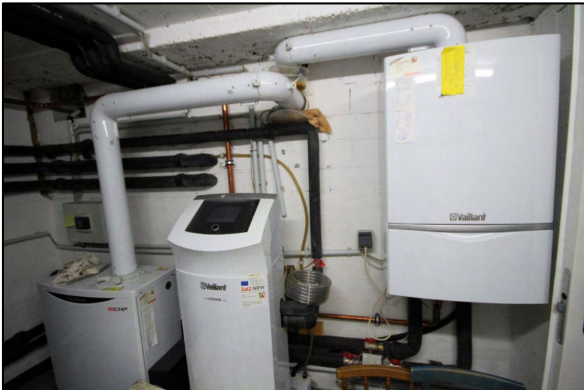
Bild 36: Gas-Heizungsanlage im ehemaligen Ölkeller
