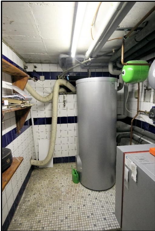
Bild 47: Warmwasserspeicher im Kellergeschoss
