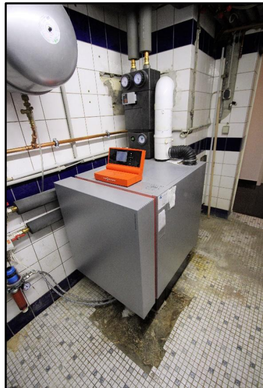
Bild 46: Öl-Heizungsanlage im Kellergeschoss
