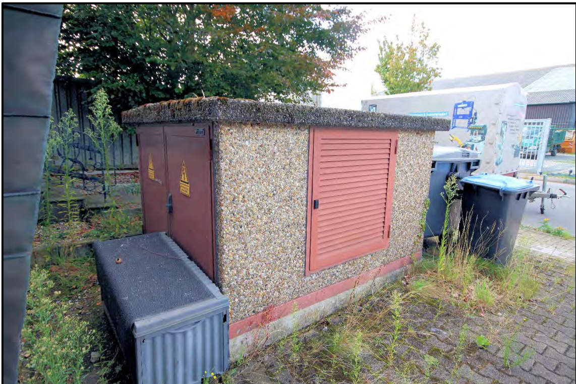
Bild 12: 10 kV-Station vor dem Gebäude Von-Braun-Straße 20
