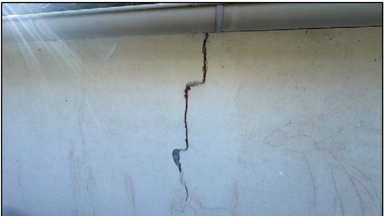
Nebengebäude: Rissbildung an der Außenwand
