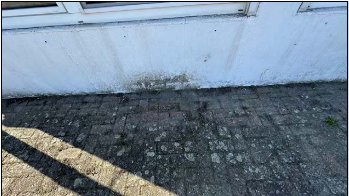
Nebengebäude: Feuchtschäden an der Außenwand
