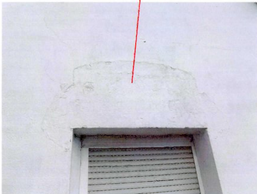
Ausschnitt Südwestseite mit Hinweis auf einfache handwerkliche Leistung von Beiputzarbeiten und leichte Rissbildungen
