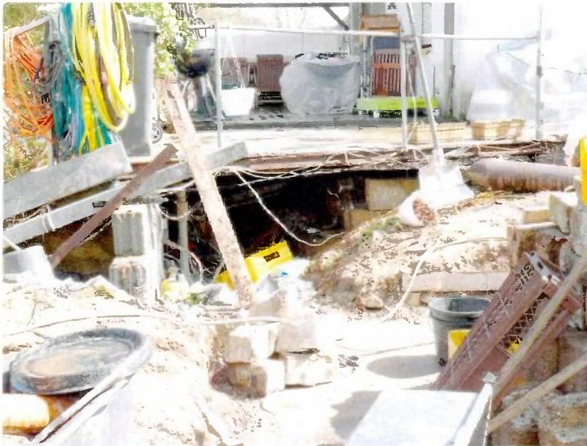
Detail Hauszuwegung / Terrasse - ob die Standsicherheit der Konstruktion gegeben ist, konnte nicht festgestellt werden
