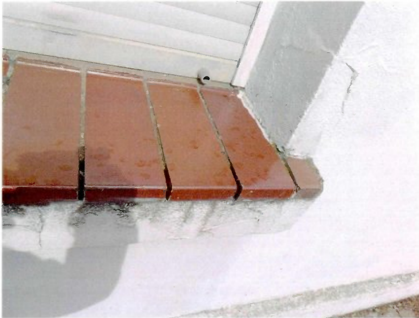
weiteres Detail Südwestseite mit ausgebrochenen Fugen der Klinker und Rissbildungen pp.
