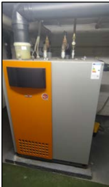
Heizungsanlage (befindet sich im mittleren Mehrfamilienhaus „Luisenstraße 46“)
