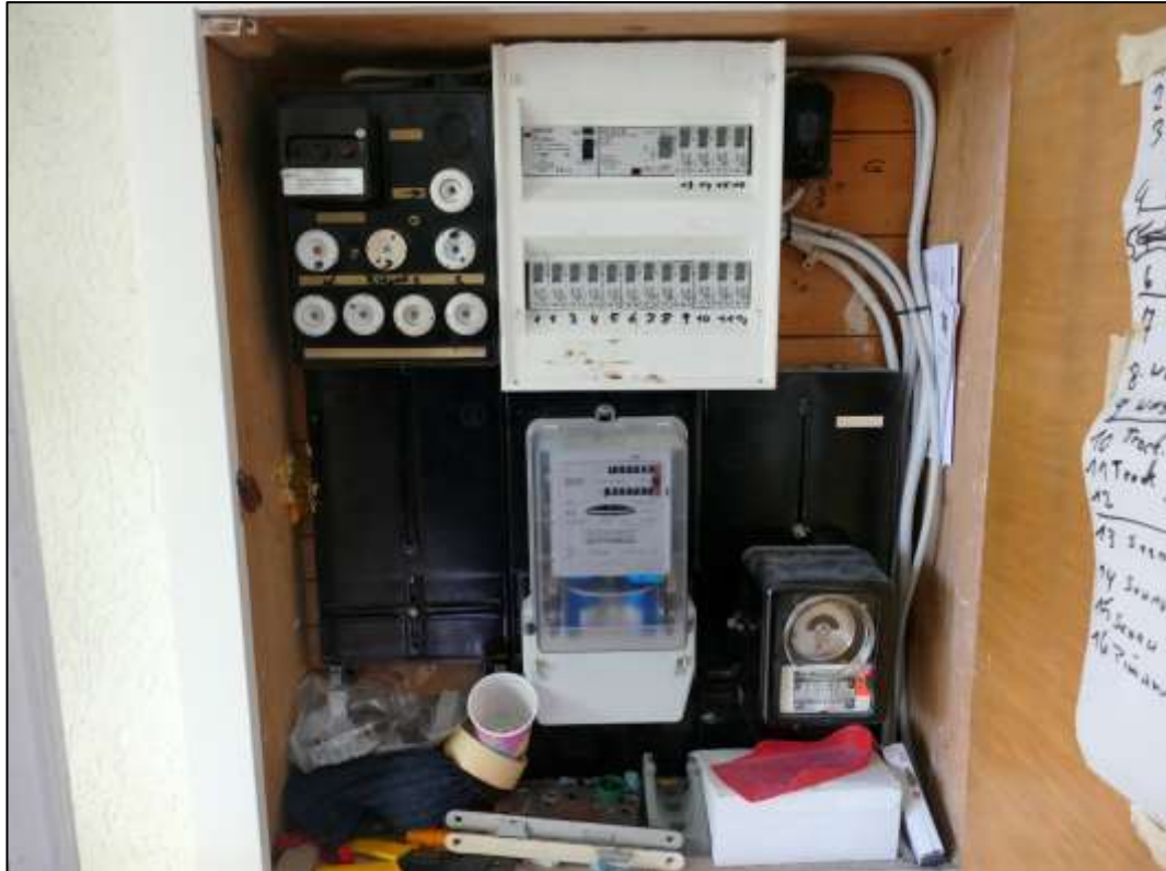
Elektro-Installation techn. überaltert
