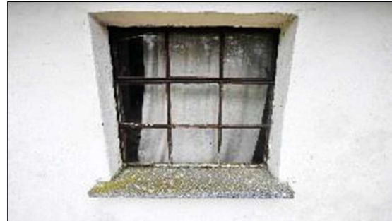
Bild 34: Unterhaltungsstau/Schäden ehem. Ökonomiegebäude (Beispiel)
