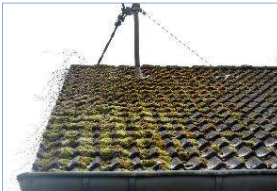
Bild 25: Unterhaltungsstau/Schäden Wohnhaus (Beispiel)
