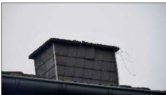
Bild 27: Unterhaltungsstau/Schäden Wohnhaus (Beispiel)
