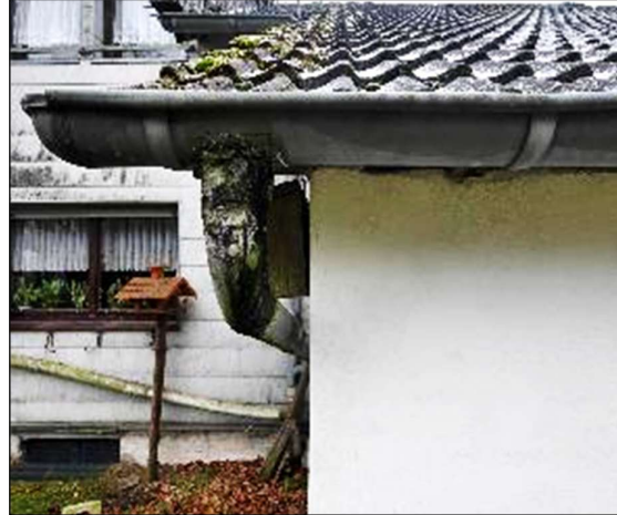
Bild 30: Unterhaltungsstau/Schäden ehem. Ökonomiegebäude (Beispiel)
