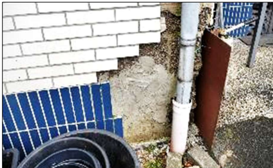
Bild 23: Unterhaltungsstau/Schäden Wohnhaus (Beispiel)
