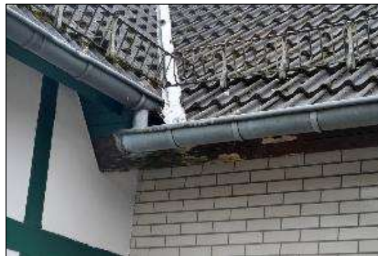
Bild 26: Unterhaltungsstau/Schäden Wohnhaus (Beispiel)
