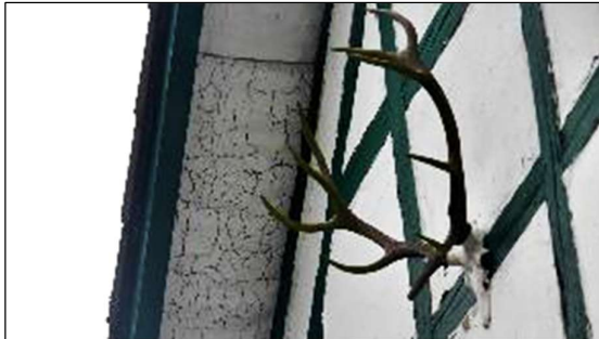
Bild 33: Unterhaltungsstau/Schäden ehem. Ökonomiegebäude (Beispiel)
