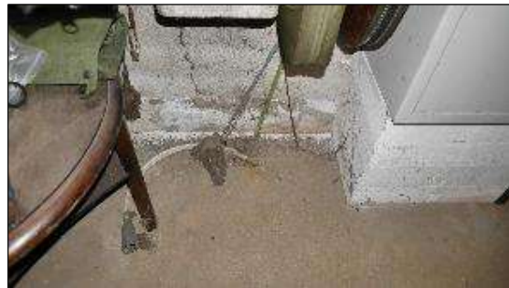
Bild 20: Unterhaltungsstau/Schäden Wohnhaus (Beispiel)
