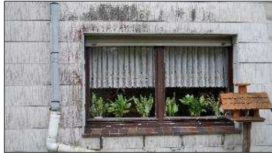
Bild 22: Unterhaltungsstau/Schäden Wohnhaus (Beispiel)
