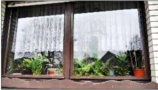
Bild 21: Unterhaltungsstau/Schäden Wohnhaus (Beispiel)
