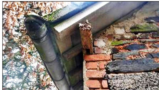
Bild 32: Unterhaltungsstau/Schäden ehem. Ökonomiegebäude (Beispiel)
