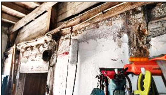
Bild 35: Unterhaltungsstau/Schäden ehem. Ökonomiegebäude (Beispiel)
