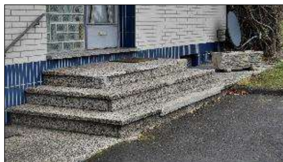
Bild 28: Unterhaltungsstau/Schäden Wohnhaus (Beispiel)
