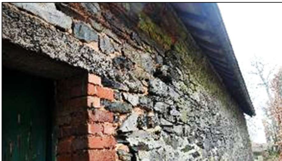
Bild 31: Unterhaltungsstau/Schäden ehem. Ökonomiegebäude (Beispiel)
