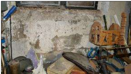
Bild 19: Unterhaltungsstau/Schäden Wohnhaus (Beispiel)
