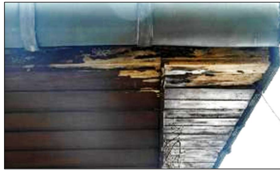
Bild 24: Unterhaltungsstau/Schäden Wohnhaus (Beispiel)
