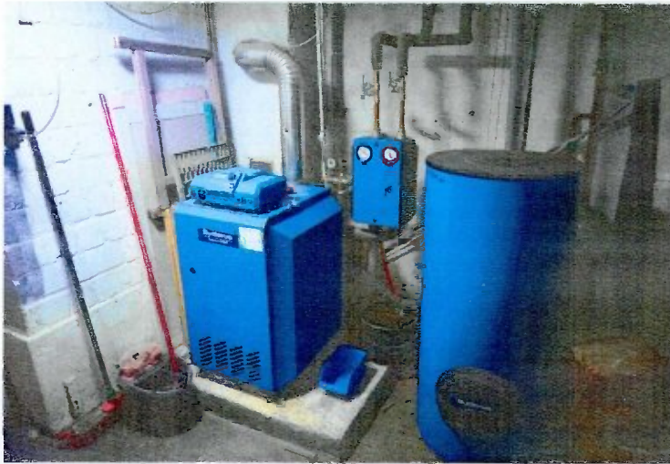
Heizung im Kellergeschoss
