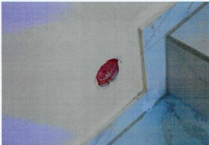
Fehlende Lampen im Treppenbereich
