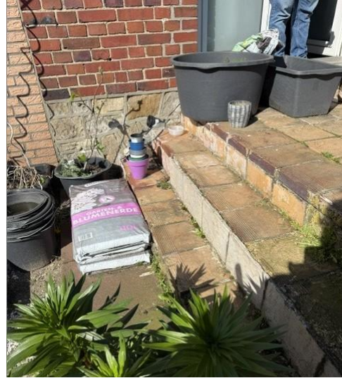
Bild 22: schadhafte Stufen Terrasse
