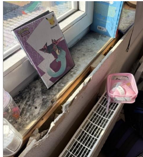
Bild 16: schadhafte Verkleidung Wohnraum (ehem. Balkon)
