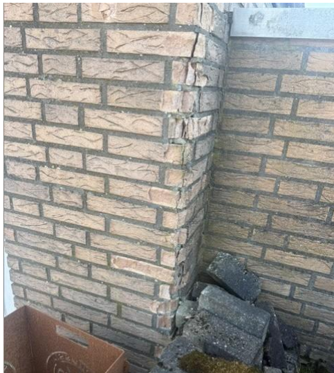
Bild 27: schadhafte Klinkerfassade Garage
