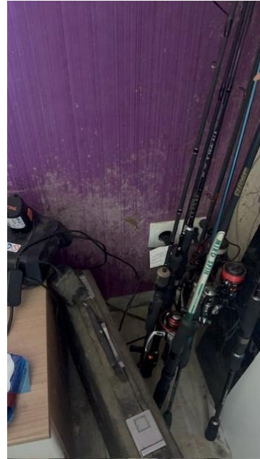
Bild 10: Feuchtigkeit, Schimmelbildung, Außenmauerwerk Wohnraum EG
