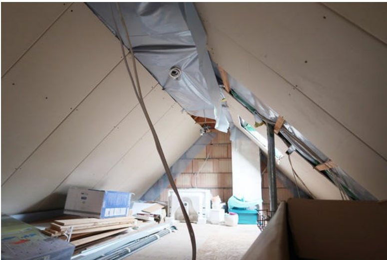
Spitzboden – Dachschrägen teilweise bekleidet, Dampfbremse schadhaft, Dämmung nicht intakt.
