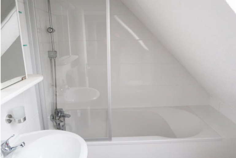
Bad DG - Einbauwanne/Waschbecken.
