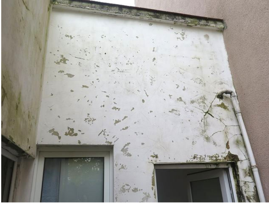
3) Ansicht vom Innenhof Fassade mit Feuchtigkeitsschäden
