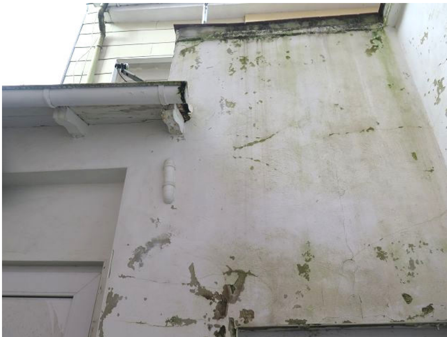
4) Ansicht vom Innenhof Fassade mit Feuchtigkeitsschäden
