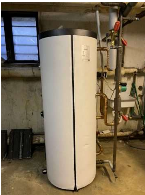
Bild 27: Richterskamp 2 – KG – Warmwasserspeicher
