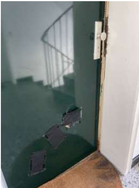
Bild 17: Richterskamp 2 – Wohnung 2. OG vorn – Wohnungstür mit Beschädigung
