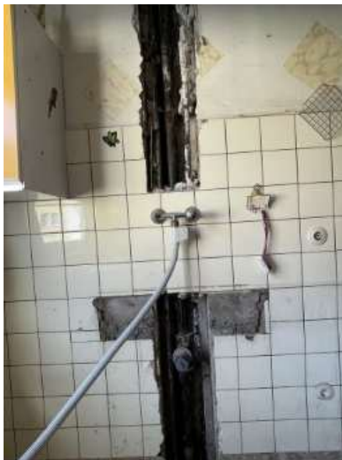
Bild 23: Richterskamp 2 – Wohnung 2. OG vorn – Küche – Löcher in der Wand als Folge eines bereits behobenen Rohrbruchs
