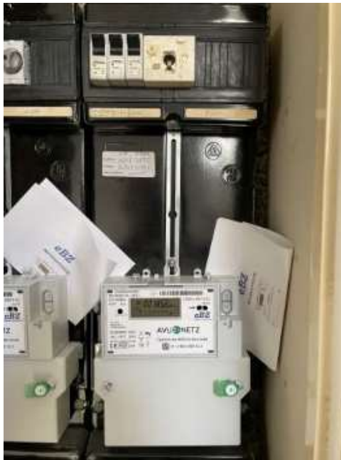
Bild 25: Richterskamp 2 – Wohnung 2. OG vorn – Sicherungen / Stromzähler
