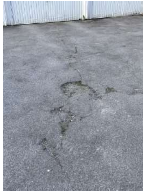
Bild 30: Risse und Ausbrüche im Asphaltbelag im Hof
