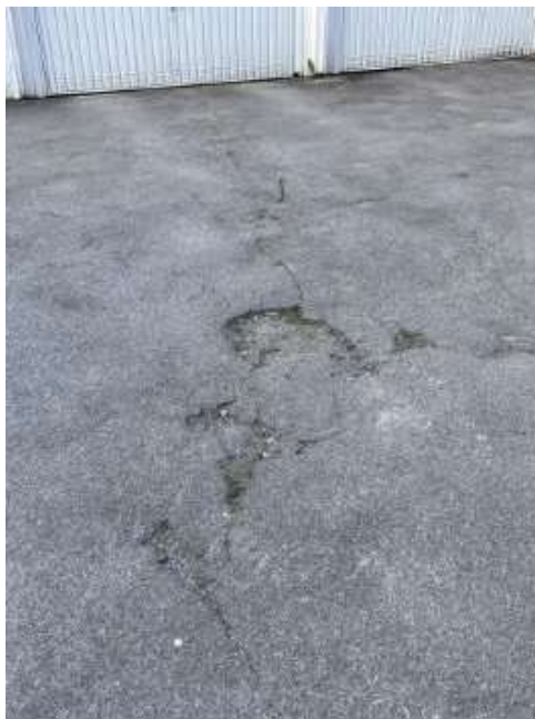
Bild 23: Risse und Ausbrüche im Asphaltbelag im Hof
