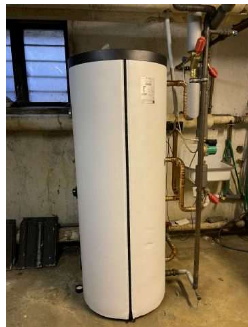
Bild 20: Richterskamp 2 – KG – Warmwasserspeicher
