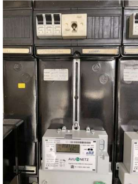
Bild 18: Richterskamp 2 – Wohnung 1. OG hinten – Sicherungen / Stromzähler
